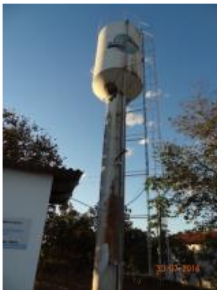
Foto 4 – Reservatório com pintura desgastada
