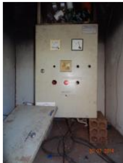
Foto 5 – Quadro de comando solto
