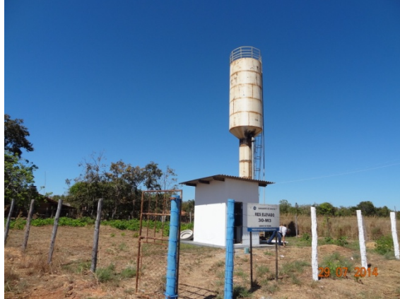
Foto 1 – Reservatório com pintura desgastada
