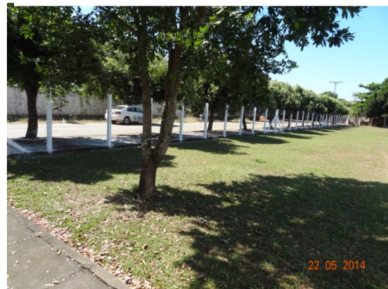
Foto 04 – Cerca de proteção danificada
