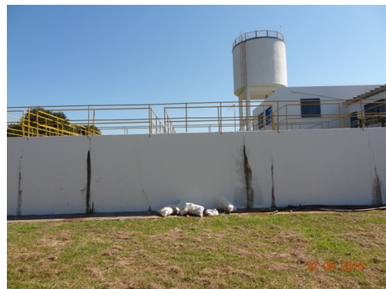
Foto 06 – Eflorescência, infiltrações e trincas - ETA
