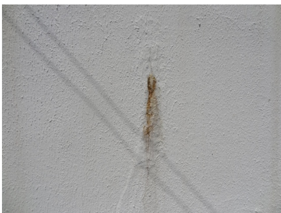
Foto 1 - Presença de eflorescências.
