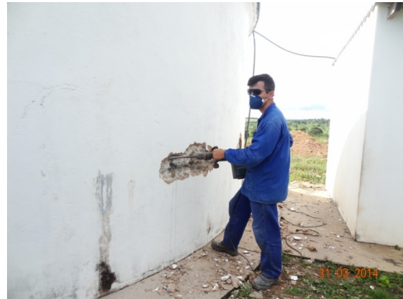
Foto 2- Solucionando trinca no
