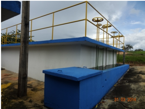
Foto 1- Correção da perda de revestimento e trinca
