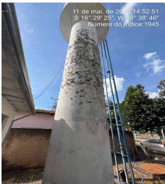
Foto 1 - C.R. REL R1 com pintura desgastada e corrosão na base do REL/R1.
