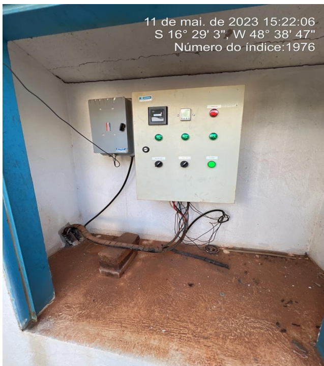
Foto 5 - Poço P1 (cidade) quadro de comando sem aviso de advertência.
