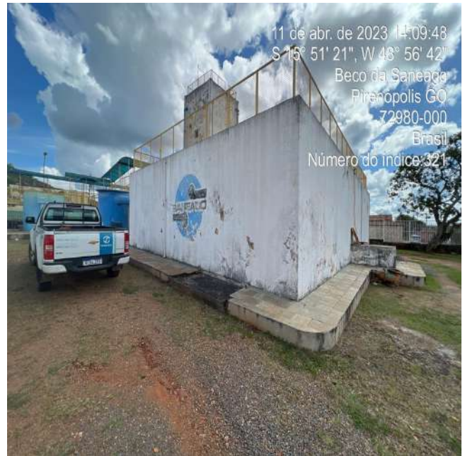
Foto 8 - RSE ETA com pintura desgastada.
