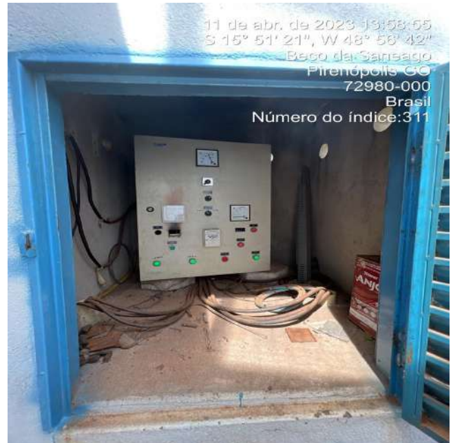
Foto 12 - Quadro de comando sem aviso de risco.
