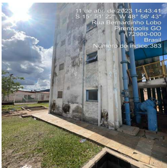
Foto 1 - Edificações da ETA com pintura desgastada.
