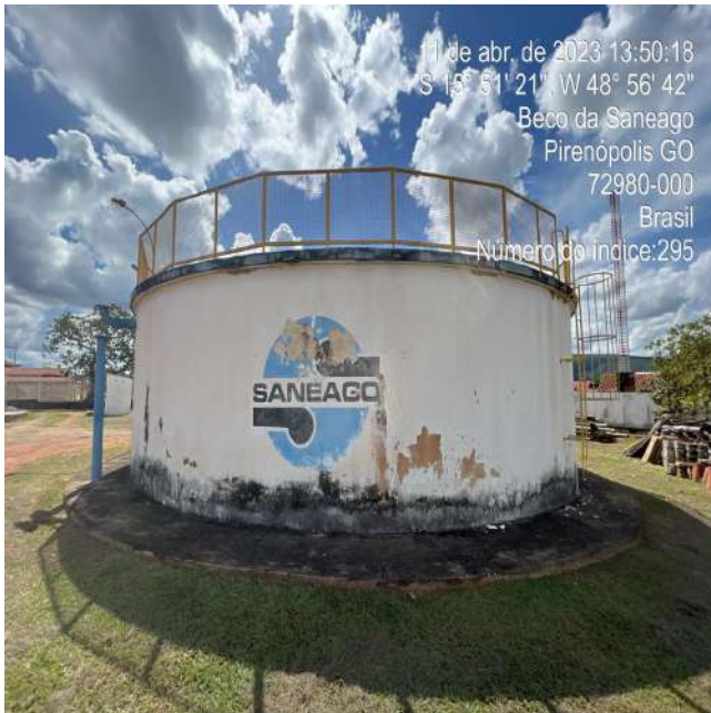
Foto 9 - RAP ETA com pintura desgastada.
