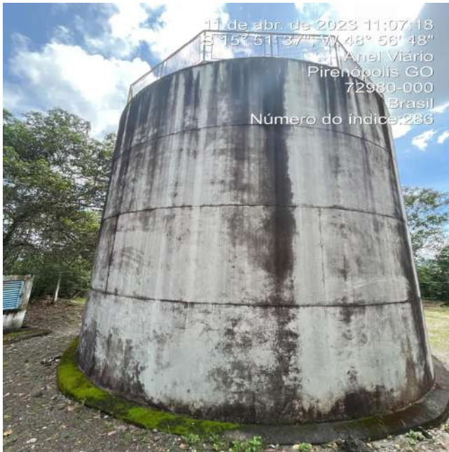
Foto7 - RAP Santa Bárbara com pintura desgastada.
