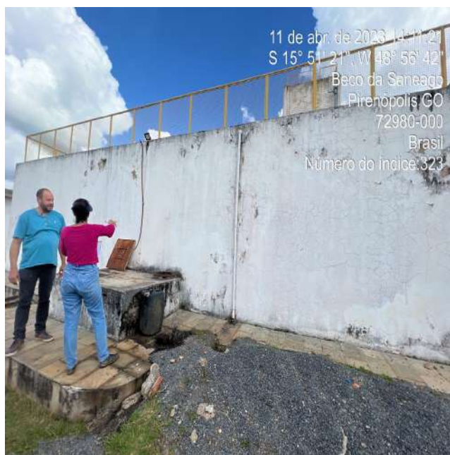
Foto 2 - Edificações da ETA com pintura desgastada.
