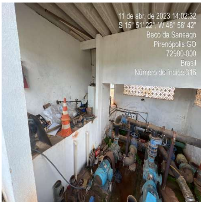
Foto 3 - EEAT/ETA com vazamento no registro.
