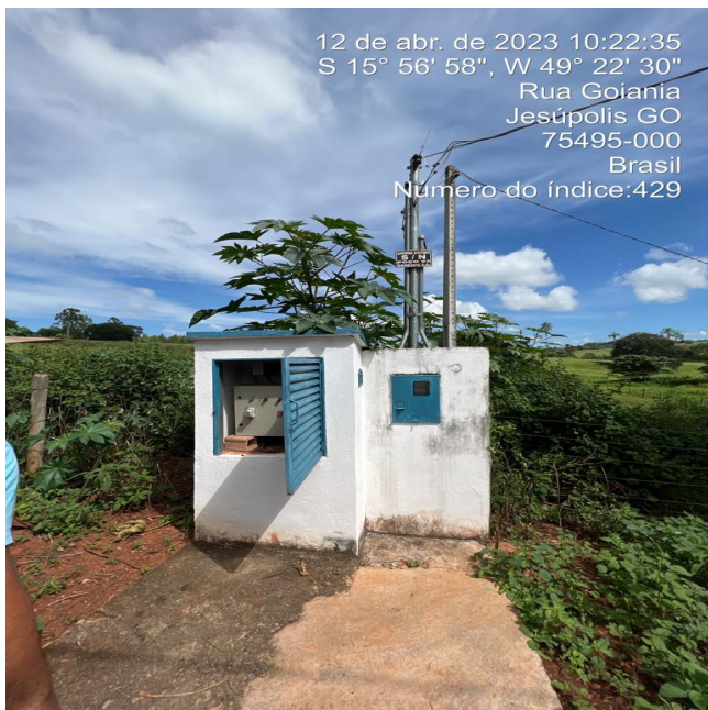
Foto 3 - Abrigo do quadro de comando sem aviso de advertência, poço P 1.
