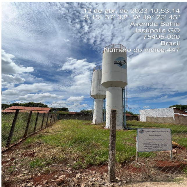
Foto 1 - CR de Jesúpolis com reservatórios com pintura desgastada.
