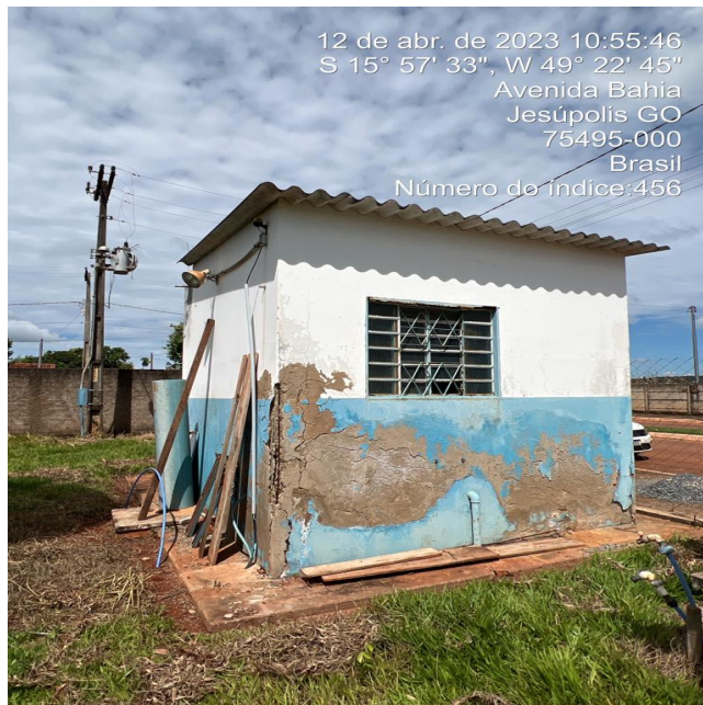
Foto 2 - Casa de química do CR de Jesúpolis com perda de revestimento e pintura desgastada.
