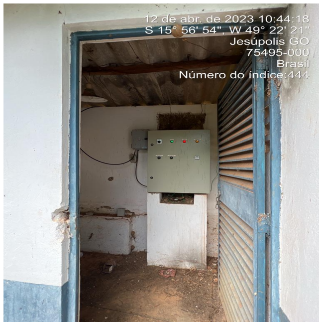
Foto 4 - Abrigo do quadro de comando sem aviso de advertência, poço P 3.
