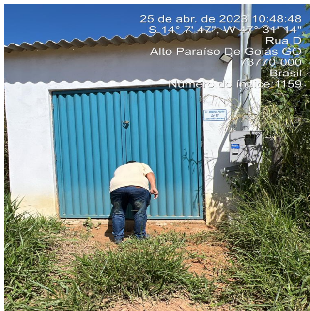
Foto 4 - EEAT/Booster Eldorado sem urbanização.
