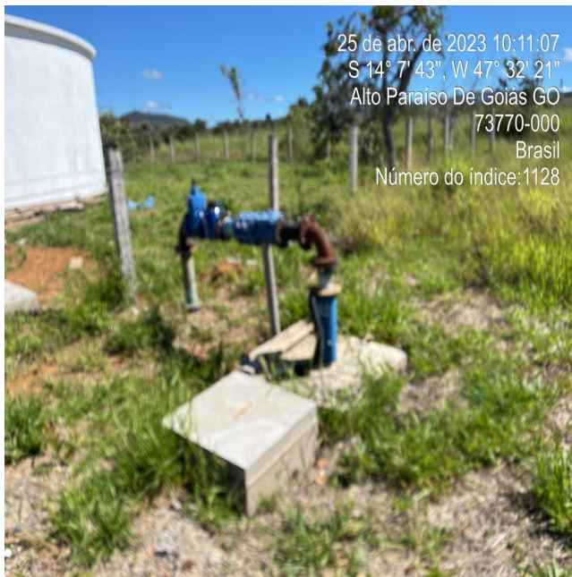
Foto 7 - Poço 03 com obras, cerca desmanchada.
