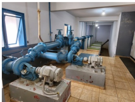
Foto 4 - Casa de Bombas - ETA
