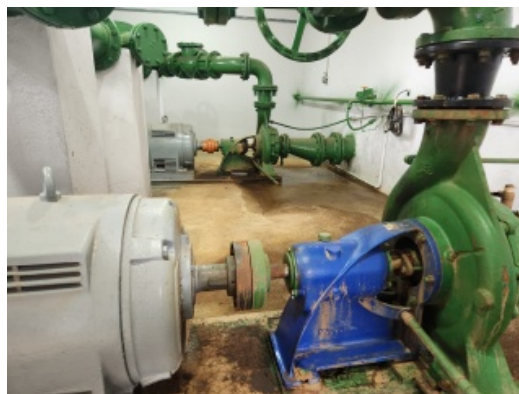
Foto 2 - Estação Elevatória de Água Bruta - EEAB
