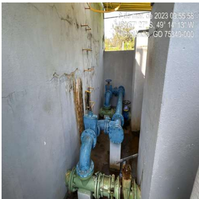
Foto 5 - ETA com vazamento nos registros dos filtros
