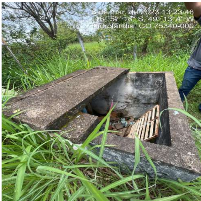
Foto 7 - Caixa de passagem com tampa danificada.
