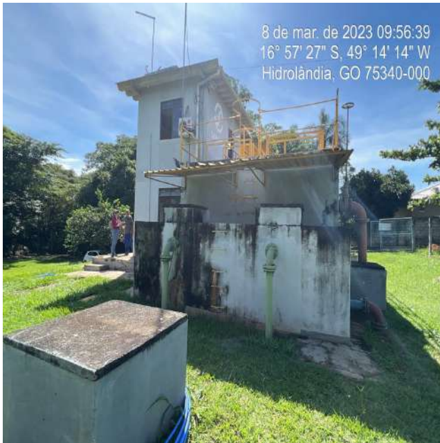
Foto 1 - Edificações da ETA com pintura desgastada.
