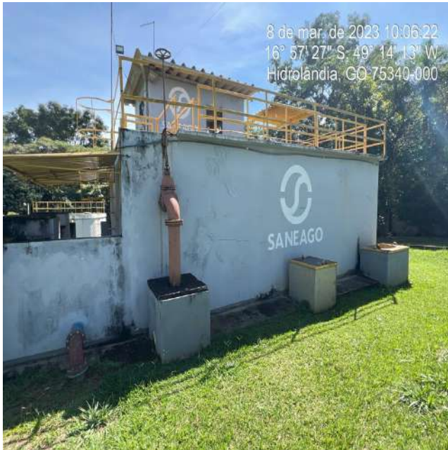
Foto 3 - ETA com infiltração na parede do floculador.
