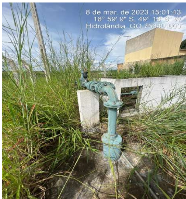
Foto 18 - Poço da rua Frei Alfredo Salton/Portal das Águas presença de mato alto.
