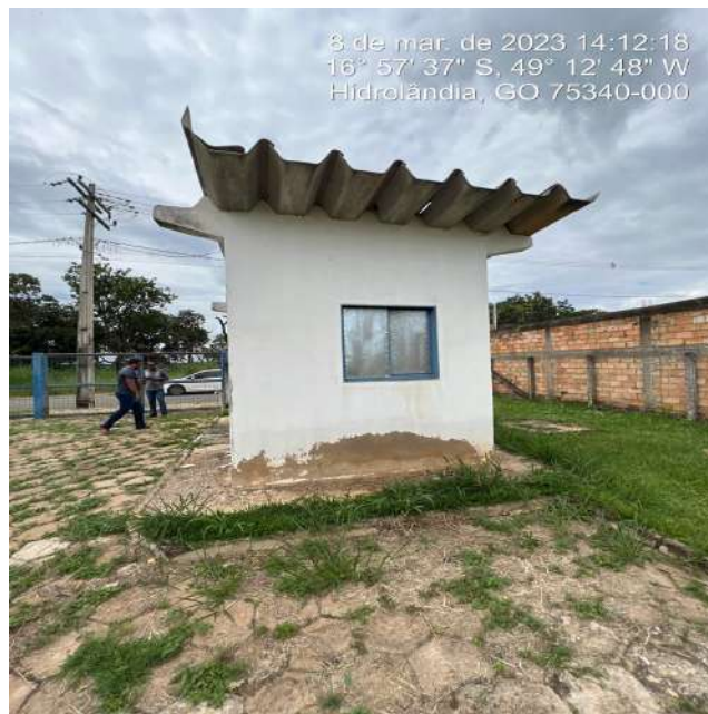
Foto 8 - Casa de química com perda de revestimento.
