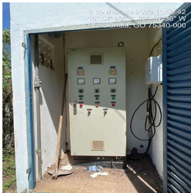
Foto 6 - Quadro de comando sem sinalização de advertência .
