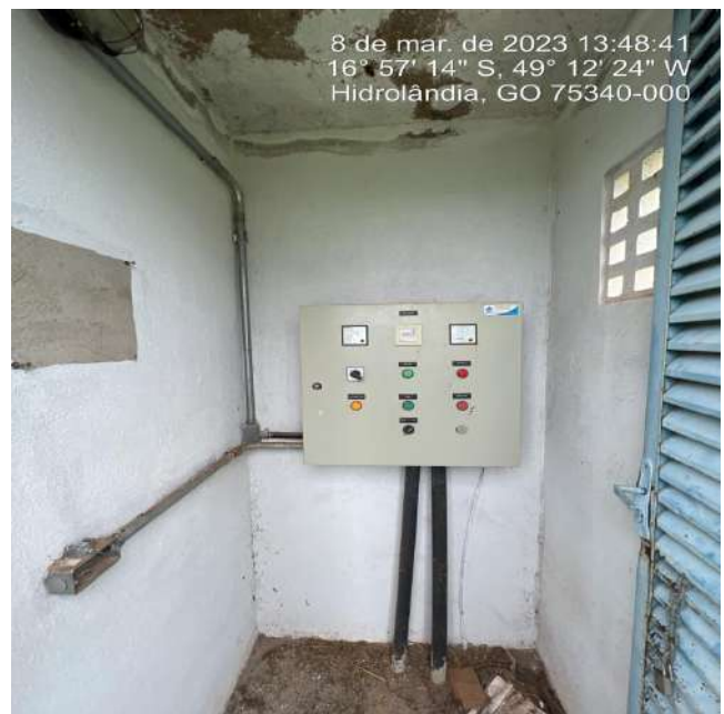
Foto 16 - Quadro de comando sem aviso de advertência.
