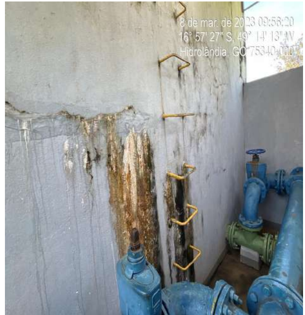
Foto 4 - ETA com infiltração na parede do decantador.
