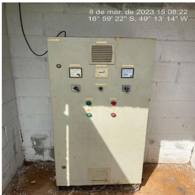
Foto 17 - Quadro de comando sem aviso de advertência.
