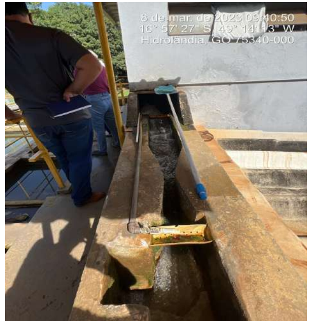
Foto 2 - Calha Parshall da ETA com infiltrações na parte inferior.
