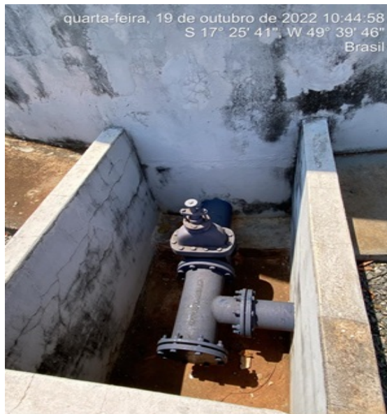
Foto 9 - Recomenda-se a inserção de grade de proteção nas caixas de passagem do CR Alto Alto Paraíso.
