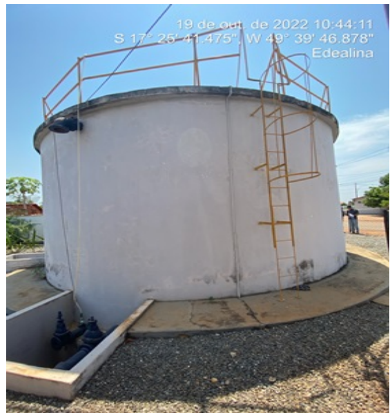
Foto 8 - RAP do CR Alto Paraíso com pintura recuperada.
