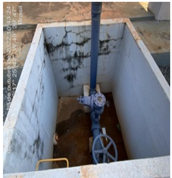
Foto 10 - Recomenda-se a inserção de grade de proteção nas caixas de passagem do CR Alto Alto Paraíso.
