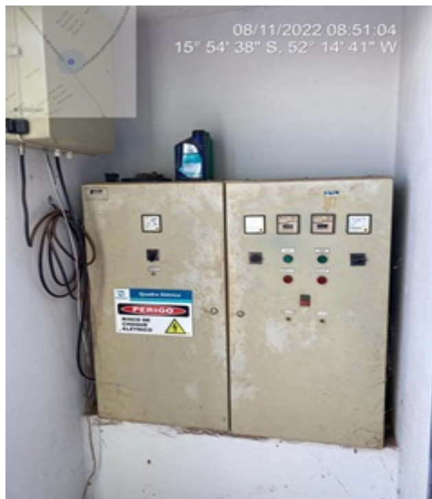
Foto 4 - Quadro de comando da EEAT/Nova Esperança com placa de aviso de risco fixada.
