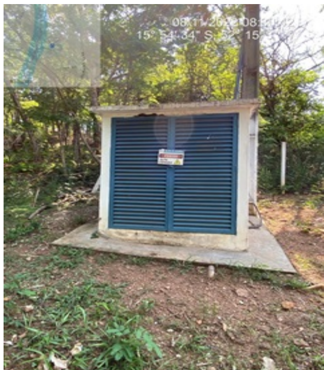
Foto 3 - Quadro de comando da EEAB/Captação com placa de aviso de risco fixado.
