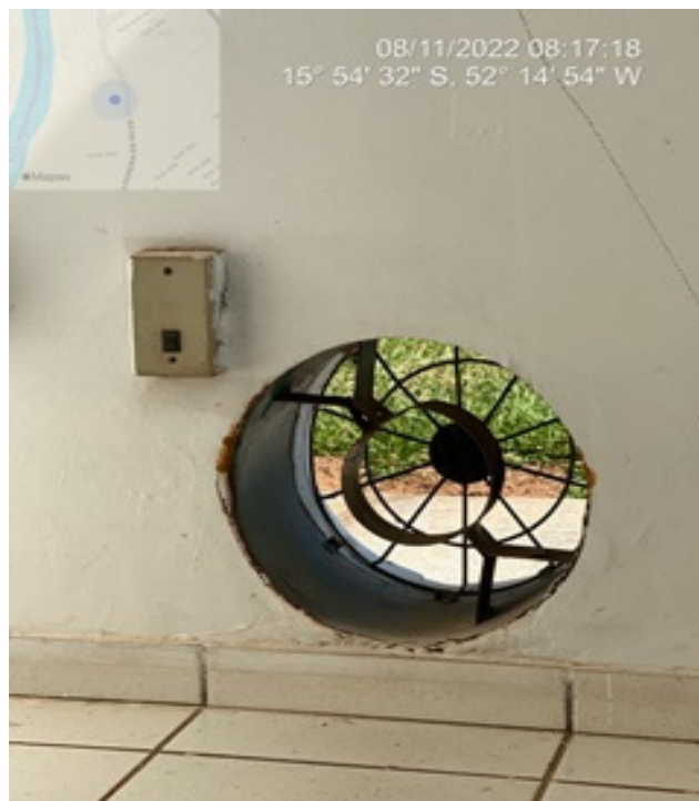
Foto 2 - ETA/Laboratório sala de desinfecção com exaustor danificado.
