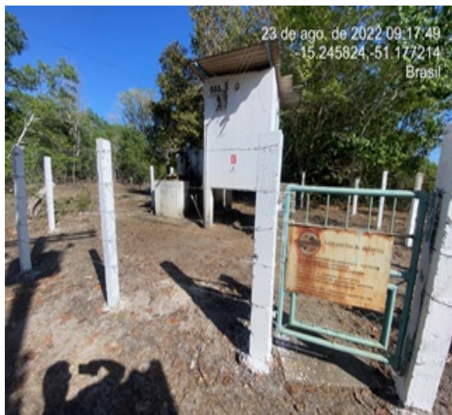
Foto 3 - EEAB desativada (em reserva).
