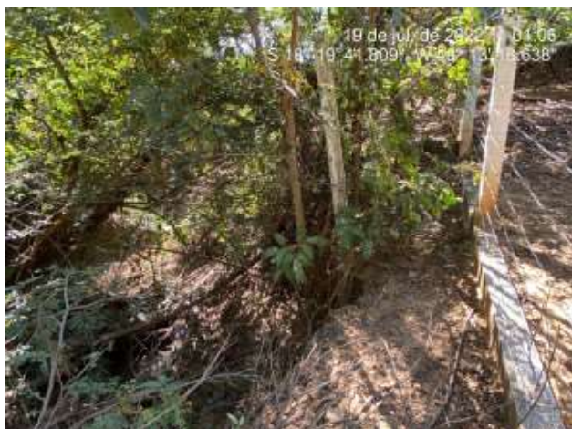
Foto 5 - processo erosivo ao fundo do poço.
