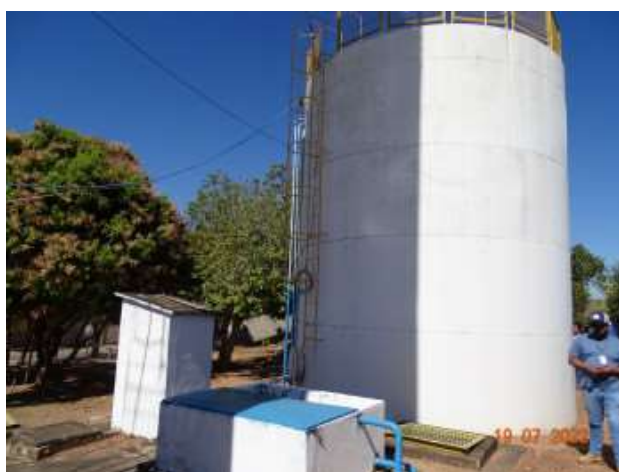
Foto 8 - RAP com ausência de corrosão e pintura recuperada e abrigo do quadro de comando da EEAT com pintura recuperada.
