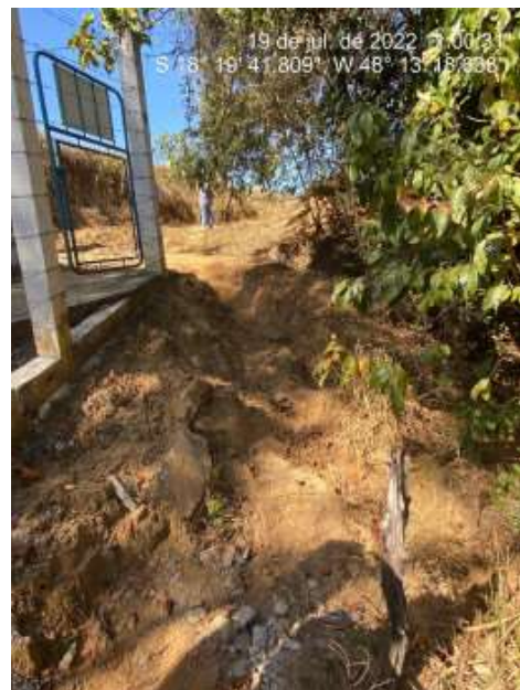
Foto 4 - processo erosivo na lateral do poço.
