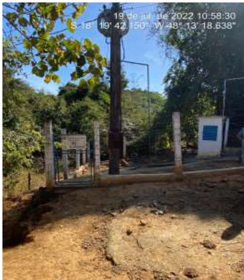
Foto 3 - processo erosivo na lateral do poço.
