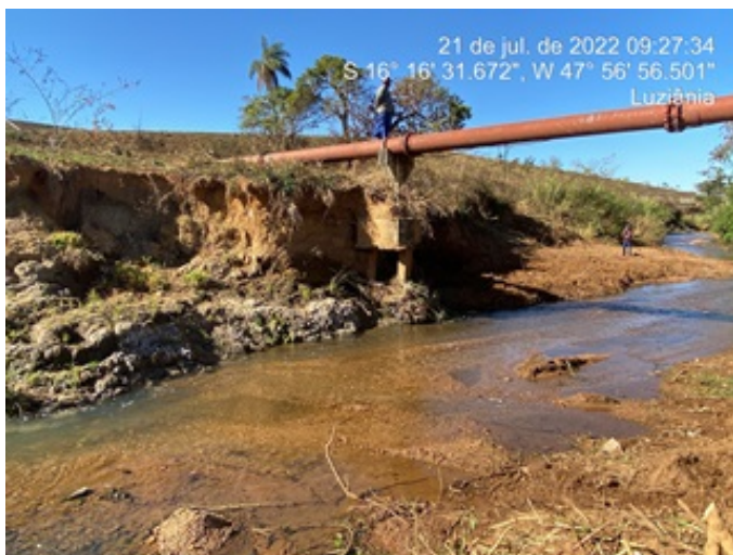
Foto 5 - Situação atual do calçamento dos pilares de sustentação das adutoras de esgoto na travessia sobre o Rio Vermelho.
