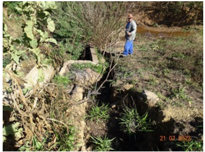
Foto 2 - Início de erosão lateral direita do talude de sustentação da calha de água pluvial.
