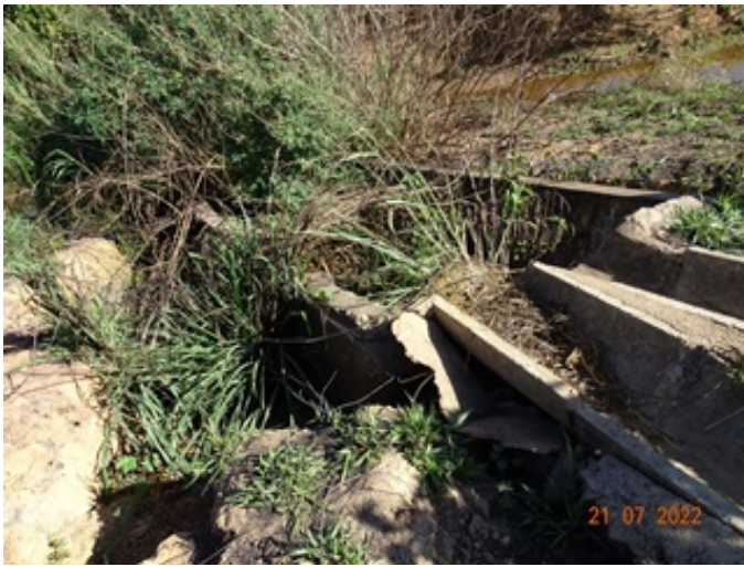
Foto 1 - Início de erosão lateral esquerda do talude de sustentação da calha de água pluvial.
