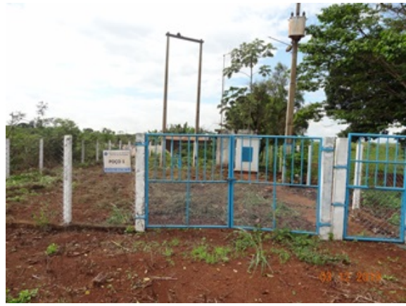
Foto 2 - Poço 01 com abrigo do quadro de comando recuperado.
