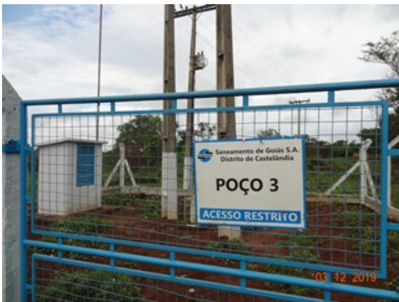
Foto 5 - Poço 03 com placa de identificação.
