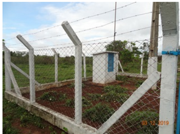
Foto 6 - Poço 03 com abrigo do quadro de comando recuperado.
