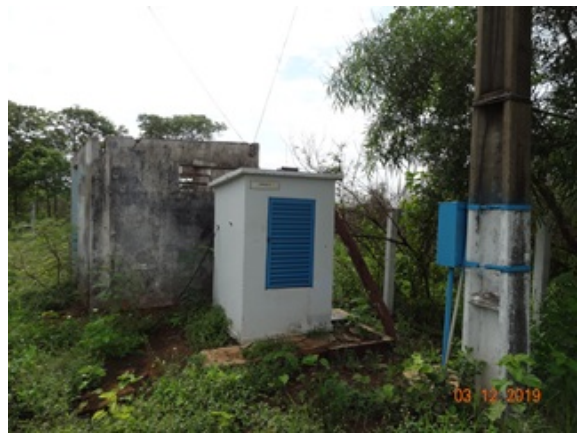
Foto 4 - Poço 02 com abrigo do quadro de comando recuperado.
