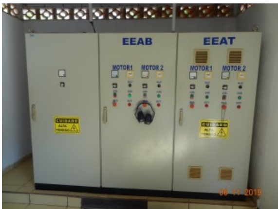
Foto 3 - Placa de advertência instalada.
