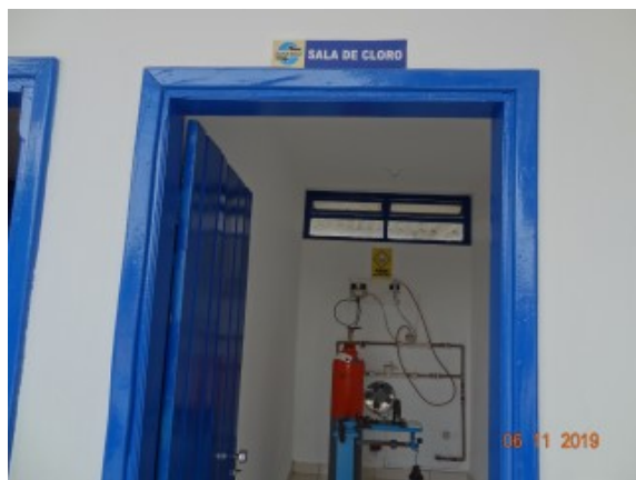
Foto 1 - Exaustor instalado na sala do clorador.
