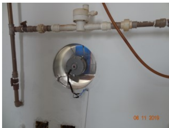
Foto 3 - Exaustor em funcionamento.
