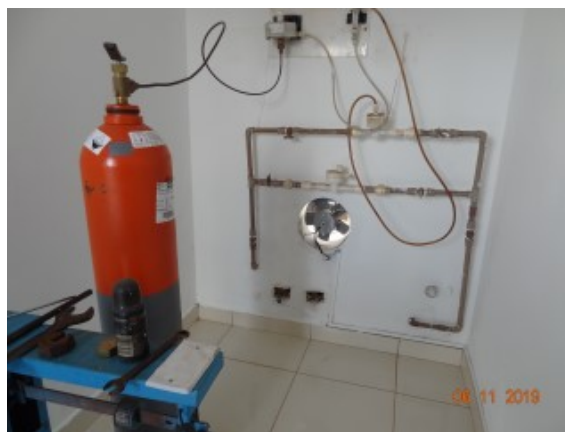
Foto 2 - Detalhe do exaustor na sala do clorador.
