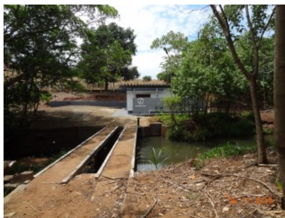
Foto 6 - Vista geral do poço de sucção EEAB.
