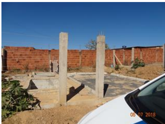
Foto 9 - Construção de uma Estação Elevatória de Esgoto na mesma área do Poço Copaíba - PGB 140.
