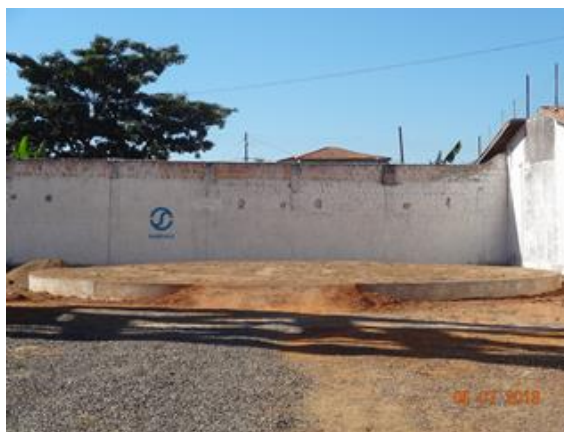
Foto 2 - Base do Reservatório de 1.000 m 3 do Sistema Serrinha
