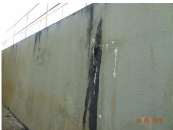
Foto 5 - infiltração na parede externa dos decantadores na ETA
