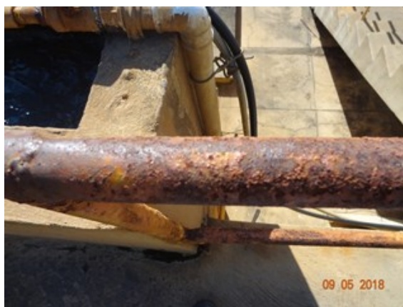
Foto 6 - Guarda corpos enferrujados na ETA
