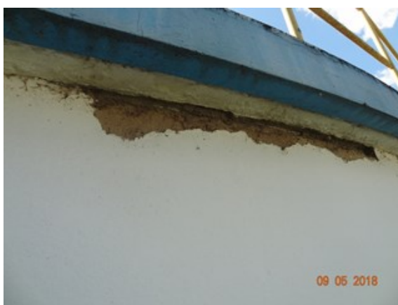
Foto 9 - Perda de revestimento no Res. Semi-enterrado 2 (borda de sustentação superior).
