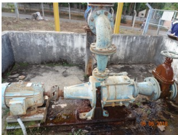
Foto 7 - Vazamento na gaxeta da EEAT Saída Caiçara.
