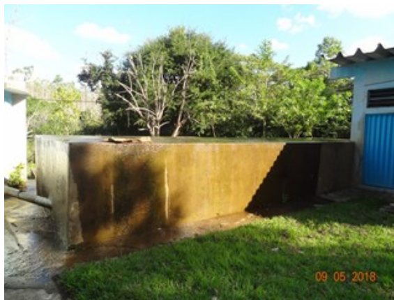
Foto 2 - Extravasamento de água no poço de sucção da EEAB
