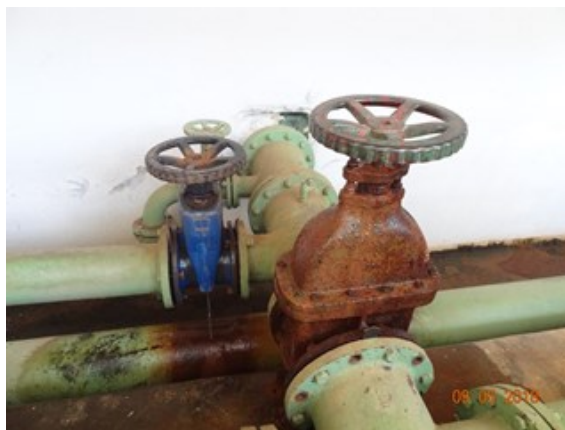
Foto 4 - Vazamento na galeria dos filtros na ETA
