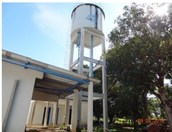
Foto 8 - Pintura desgastada no REL de lavagem de filtros
