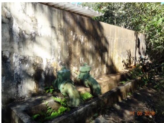
Foto 1 - EEAB 1 poço de sucção com infiltrações e eflorescências.
