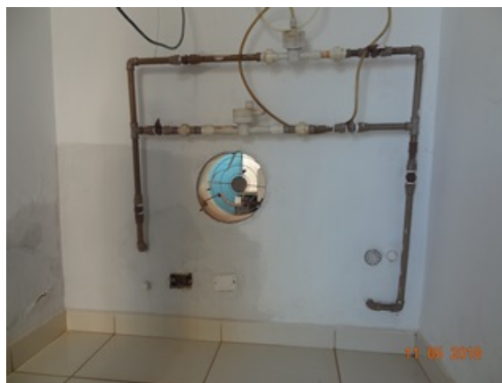
Foto 2 - Sala de cloro sem exaustor.
