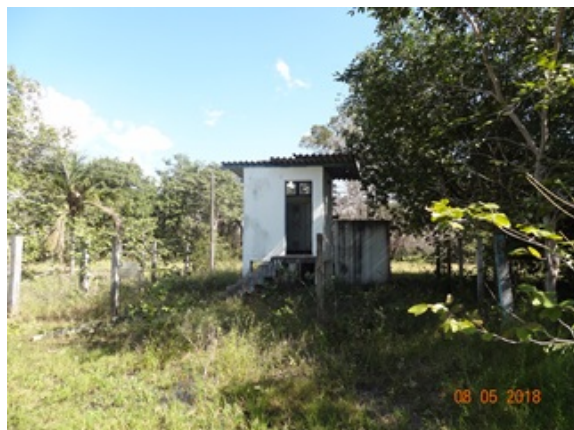
Foto 3 - EEAB com cerca de proteção danificada.
