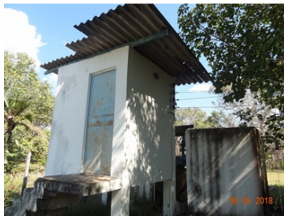
Foto 2 - EEAB com pintura desgastada nas edificações.
