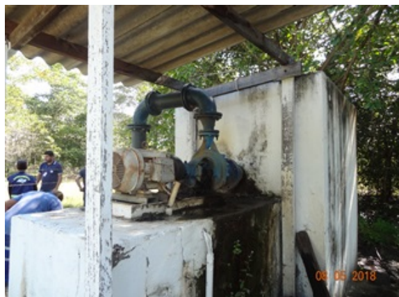
Foto 1 - EEAB com vazamento no conjunto moto-bomba.
