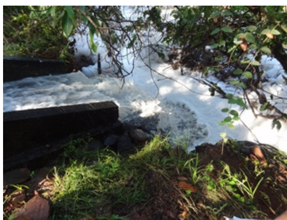
Foto 2 - Calha de descarte de efluente no corpo receptor necessitando de manutenção.
