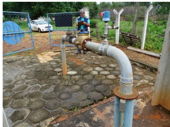
Foto 6 - Vazamento no cavalete do poço P04.
