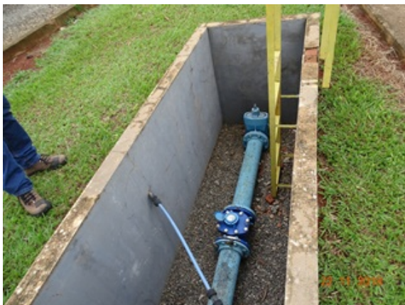
Foto 5 - Caixa de passagem REL/Distrito sem tampa ou grade de proteção.
