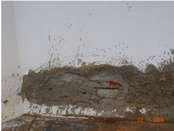
Foto 3 - Casa de química no REL/Distrito com perda de revestimento.
