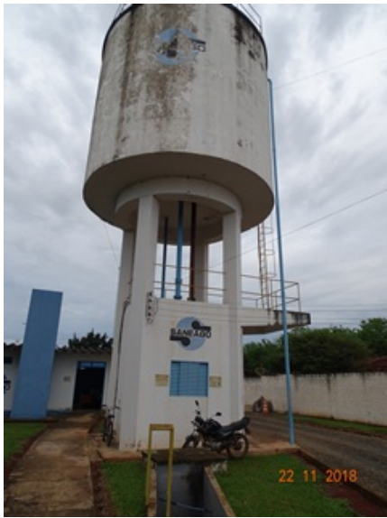
Foto 1 - Pintura desgastada REL/Distrito
