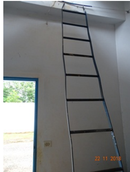
Foto 4 - Escada solta e sem guarda-corpo REL/Distrito.
