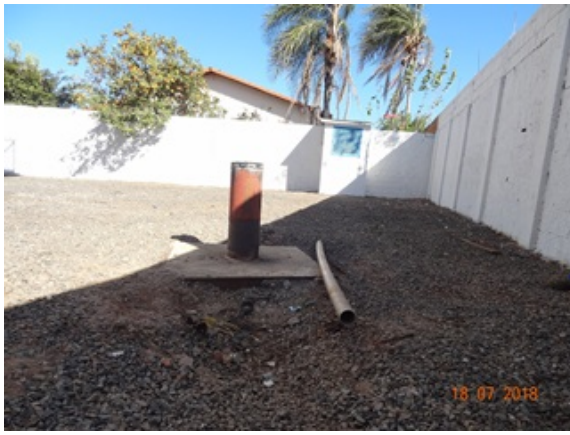
Foto 1 - Poço PGB 069 sem bomba e ligação elétrica.
