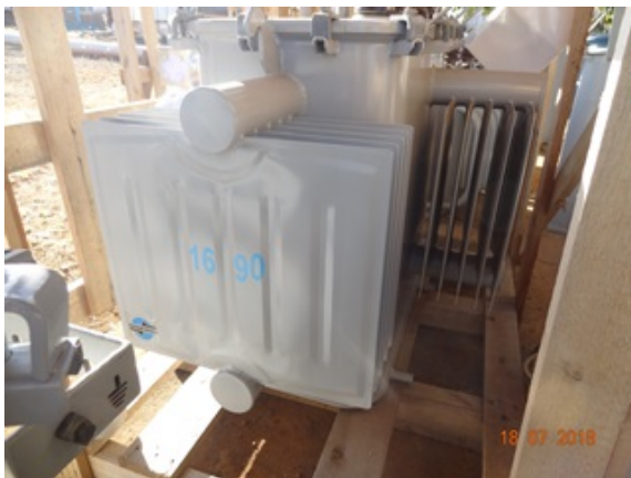
Foto 5 - Transformador adquirido a ser utilizado na futura EEAB do Cór. Dirceu.
