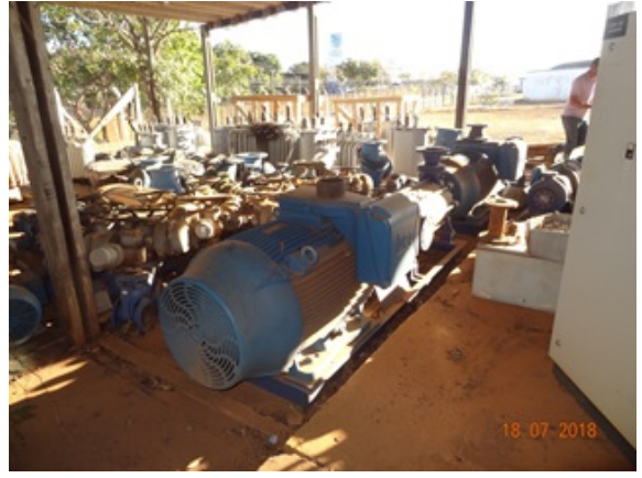
Foto 8 - Bomba adquirida para ser instalada na futura EEAB do Córr. Dirceu.
