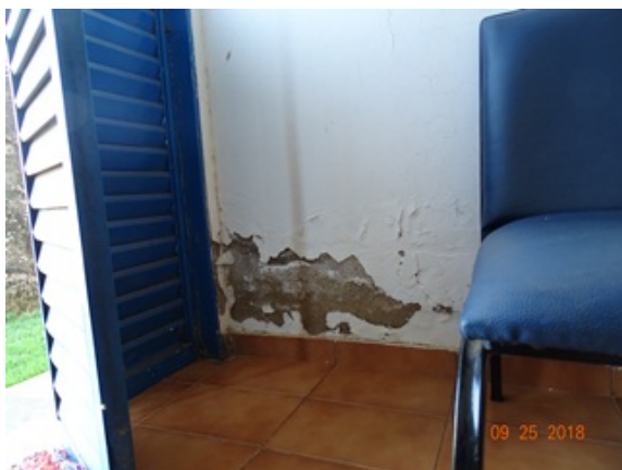
Foto 1 - Perda de revestimento argamassado.
