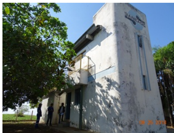
Foto 4 - Pintura desgastada na ETA.
