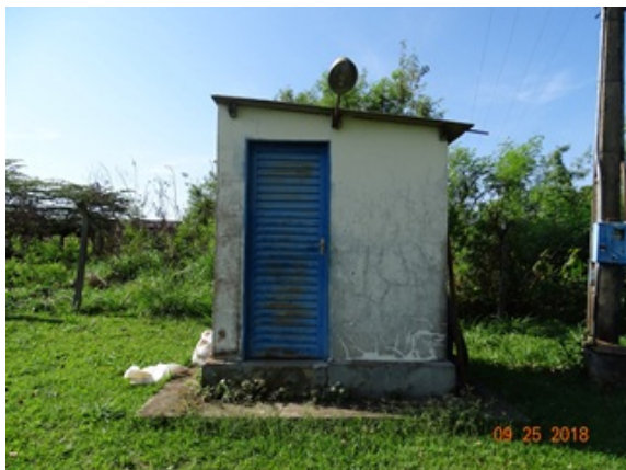
Foto 5 - Pintura desgastada EEAB.
