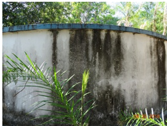
Foto 6 - Pintura desgastada RSE.
