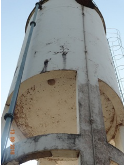
Foto 3 - Presença de infiltrações e pintura desgastada no REL/ETA
