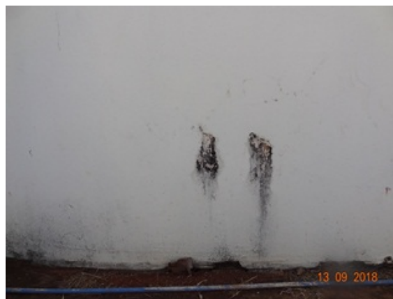
Foto 2 - Presença de infiltrações e eflorescências no RAP/CR 01
