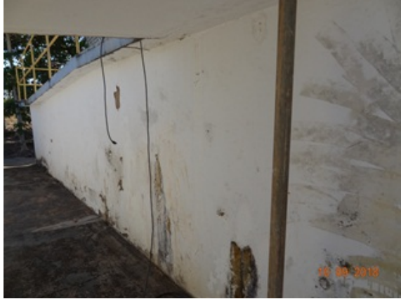
Foto 3 - Presença de infiltração.
