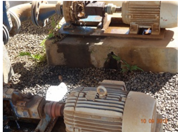
Foto 6 -Vazamento nas gaxetas.
