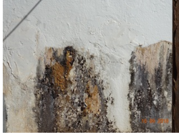
Foto 4 - Presença de infiltrações e eflorescências
