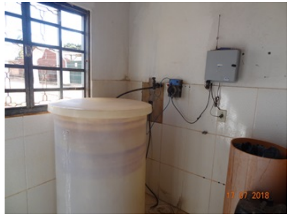
Foto 4 - Casa de cloração SAA/C.R. Mossoró.
