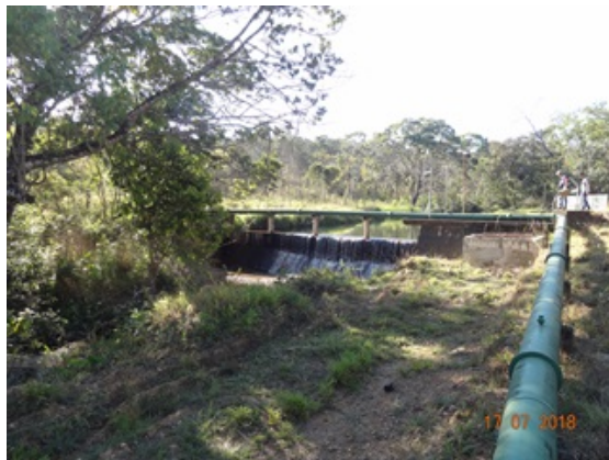
Foto 13 - Captação/EEAB Ribeirão Saia Velha, com adutora nova.
