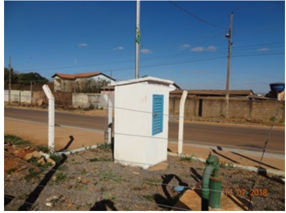
Foto 10 - Poço PMO 06 interligado ao SAA/C.R. Mossoró.
