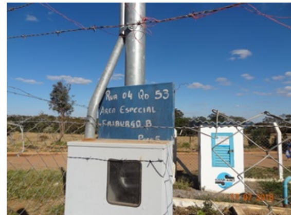
Foto 8 - Poço PMO 05 interligado ao SAA/C.R. Mossoró.
