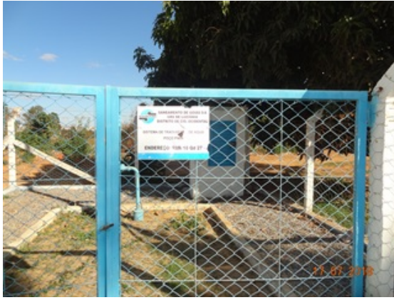
Foto 9 - Poço PMO 04 interligado ao SAA/C.R. Mossoró.
