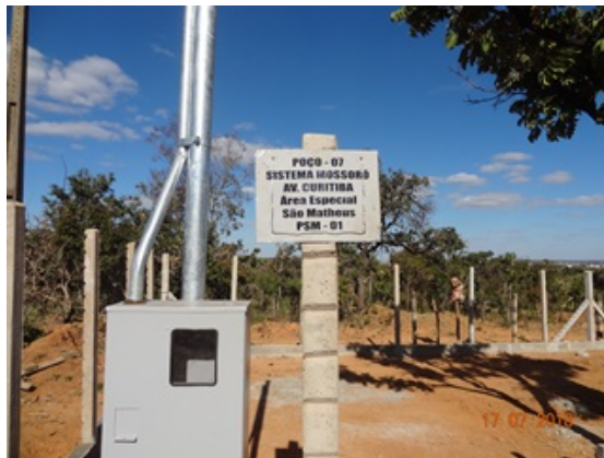
Foto 7 - Poço PO 07 vazão 43 m 3 /h, SAA/C.R. Mossoró (Av. Curitiba área especial São Mateus).
