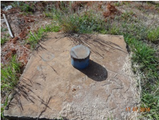
Foto 5 - Poço tubular profundo SAA/C.R. Mossoró (poço de reserva).
