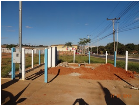
Foto 11 - Poço PMO 03 interligado ao SAA/C.R. Mossoró.
