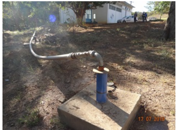
Foto 12 - Poço da captação/EEAB Ribeirão Saia Velha.
