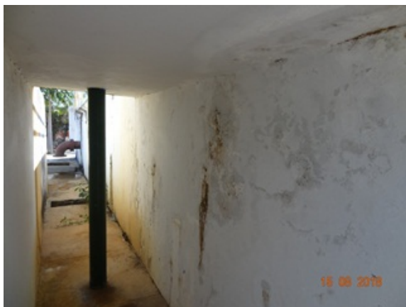
Foto 3 - Presença de infiltração galeria dos filtros.
