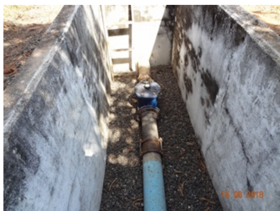
Foto 1 - Caixas de passagem tampas ou guarda corpo.
