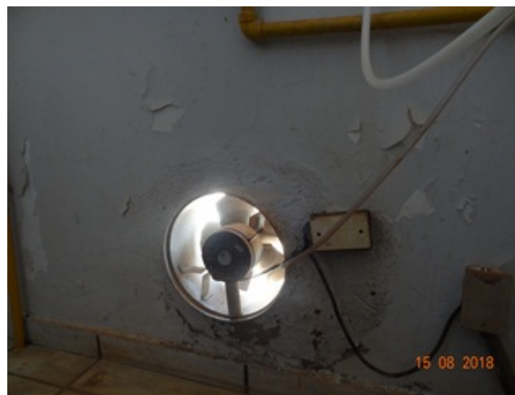
Foto 4 - Presença de infiltração e eflorescências.
