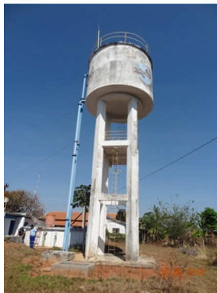
Foto 6 - REL pintura desgastada.
