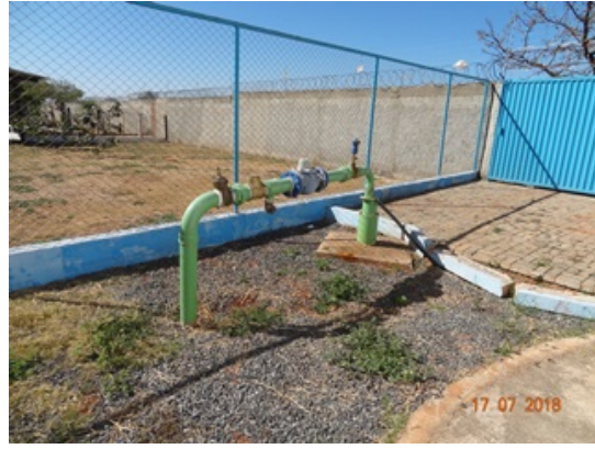
Foto 8 - Esplanada III/C.R. poço PGD 122 interligado à EEAB.
