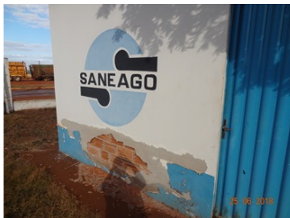
Foto 1 - Má conservação da edificação da casa de química do C. R. Bela Vista.
