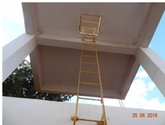
Foto 2 - Ausência de guarda-corpos na escada de acesso ao REL do C. R. Bela Vista.
