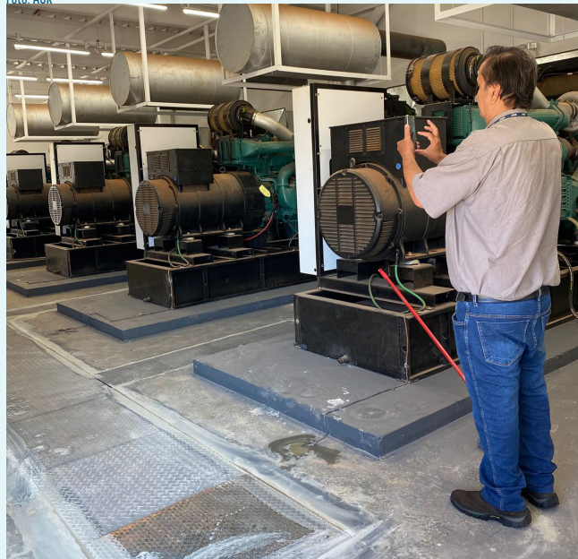
Engenheiro Glenn Oliver Canedo Mereb registrando as condições da infraestrutura no Hospital Cora
