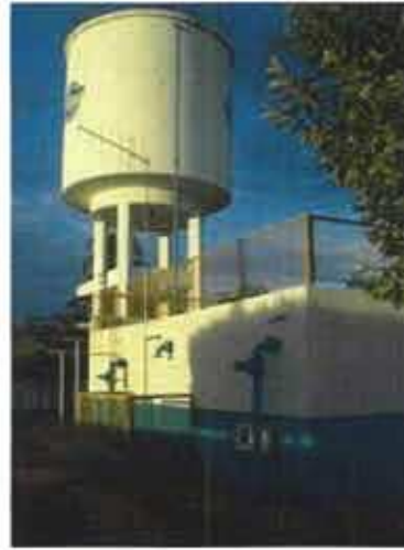
Figura 10: Reservatórios Elevado e Semi-enterrado
