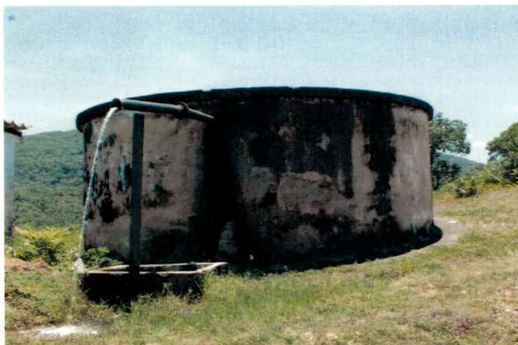
Figura 10- Reservatorio apoiado com estrutura comprometida
