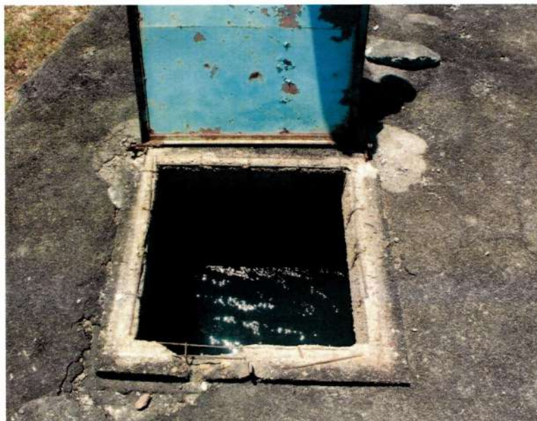
Figuta 11- Tampa da entrada de visita do reservatório, com ferrugem.
