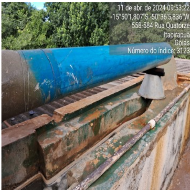
Foto 13 - Calha Parshal da ETA com pintura desgastada.
