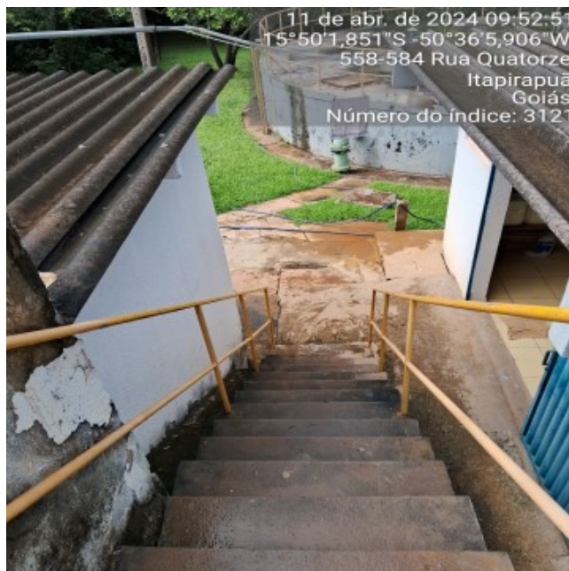
Foto 12 - Edificações da ETA com pintura desgastada.
