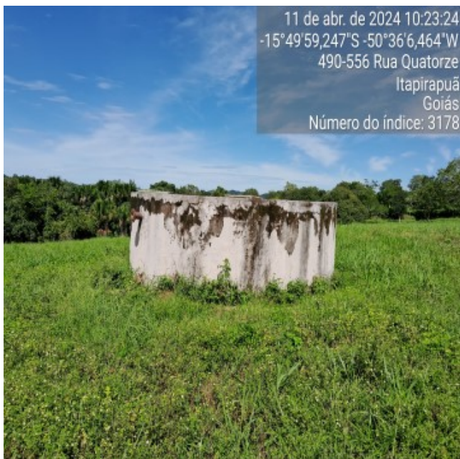
Foto 7 - RAP/ETA com pintura desgastada - lavagem de filtros.
