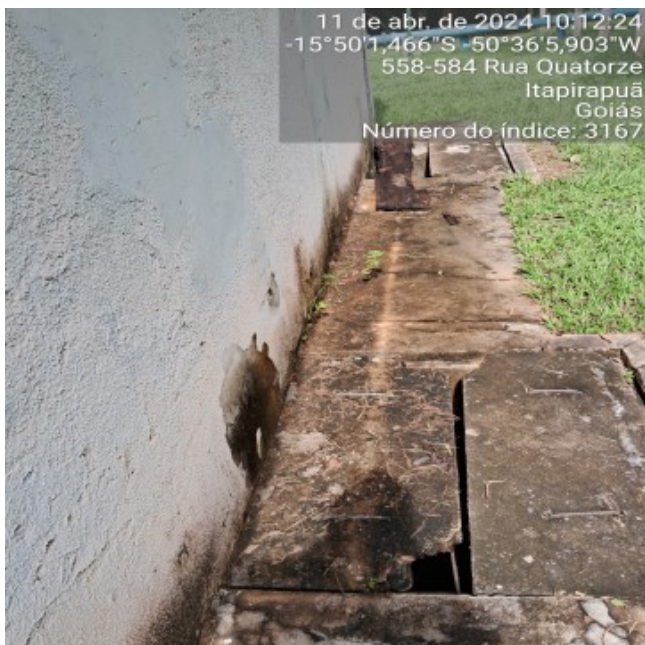
Foto 5 - Caixas de passagem com tampa danificada na área da ETA.
