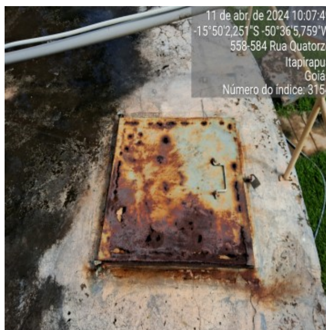
Foto 2 - RAP/ETA com tampa de inspeção danificada.
