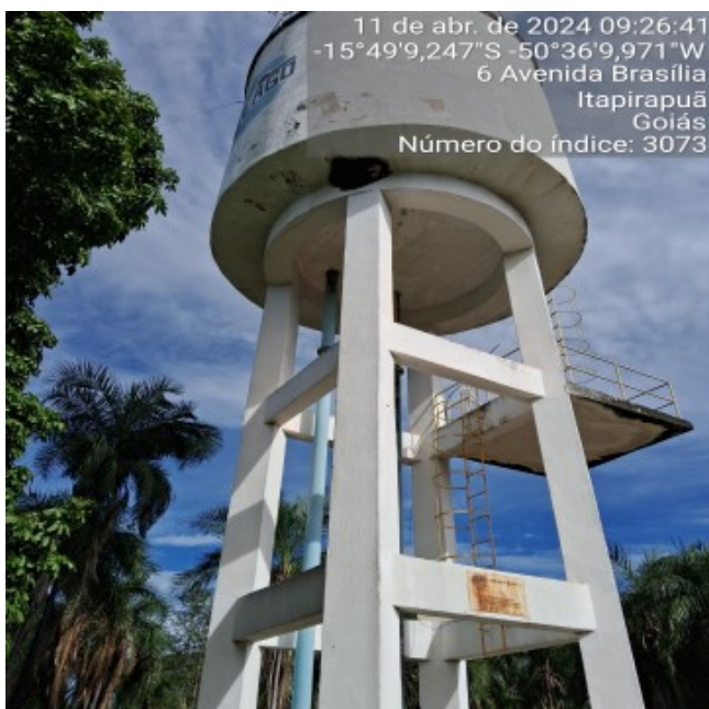
Foto 9 - REL/Distrito com pintura desgastada.
