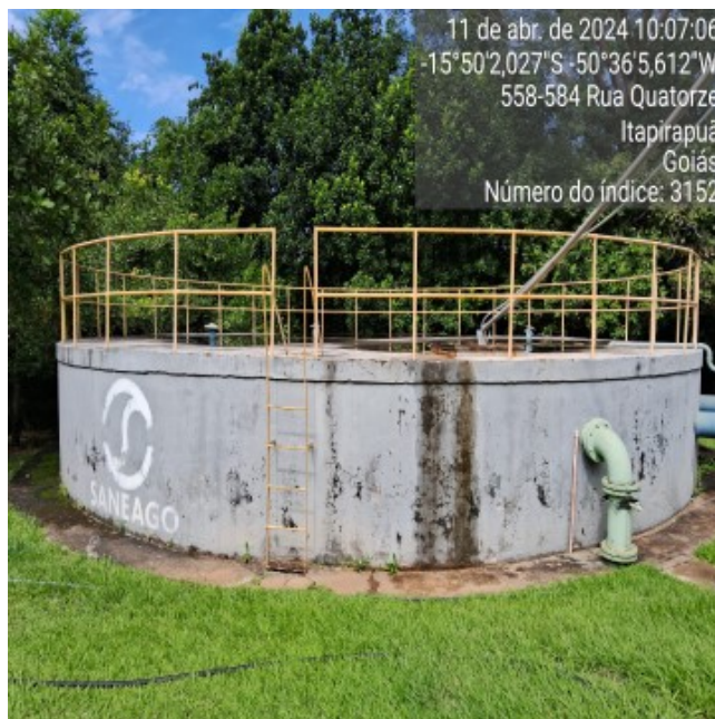
Foto 14 - RAP da ETA com pintura desgastada.
