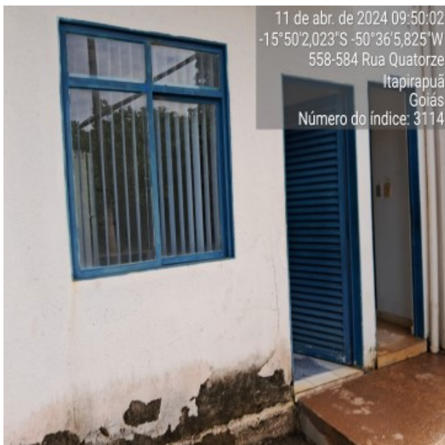
Foto 11 - Edificações da ETA com pintura desgastada.
