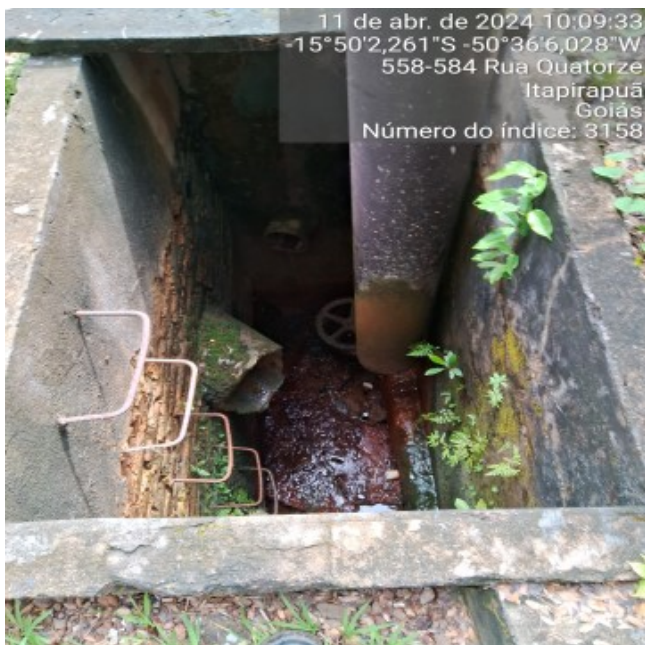
Foto 3 - Caixas de passagem sem grade de proteção na ETA.
