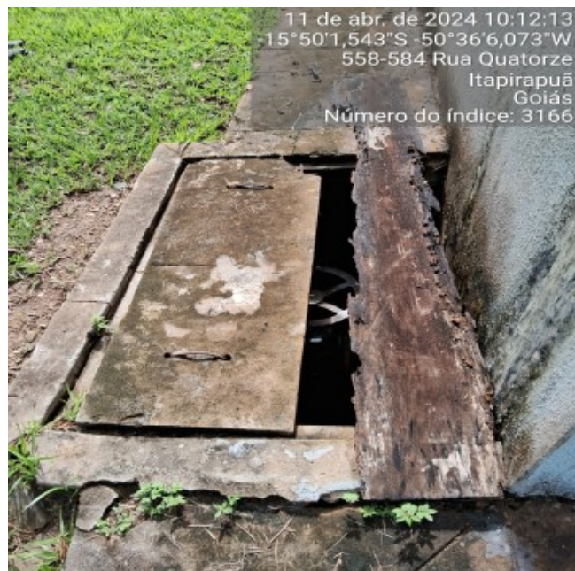
Foto 4 - Caixas de passagem sem grade de proteção na ETA.
