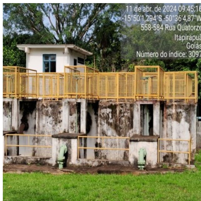
Foto 10 - Edificações da ETA com pintura desgastada.
