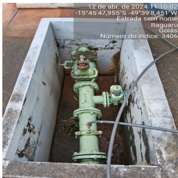
Foto 3 - ETA - Caixa de passagem sem tampa ou grade de proteção.
