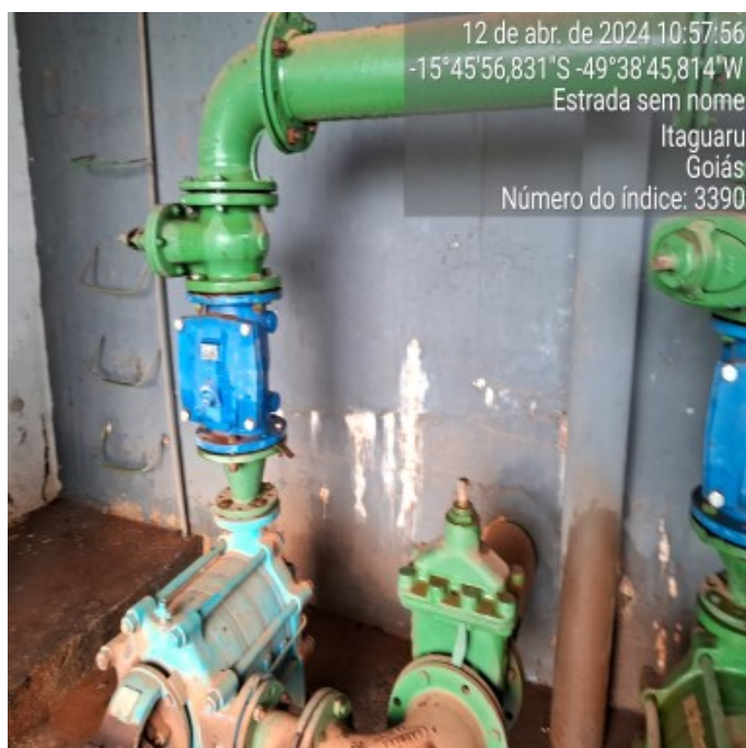
Foto 4 - RAP/EEAB intermediária com infiltrações.
