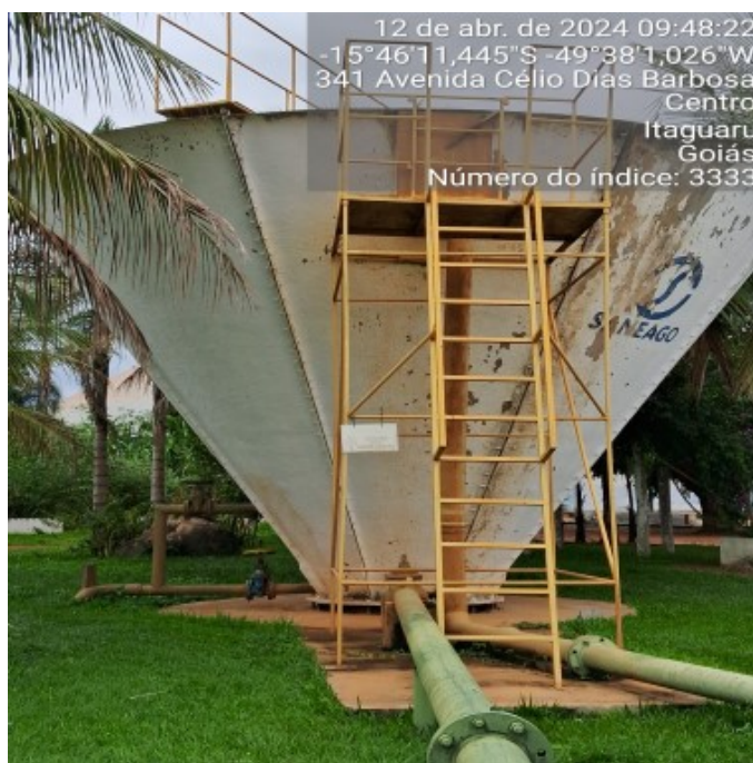
Foto 7 - ETA/Floco decantador com pintura desgastada.
