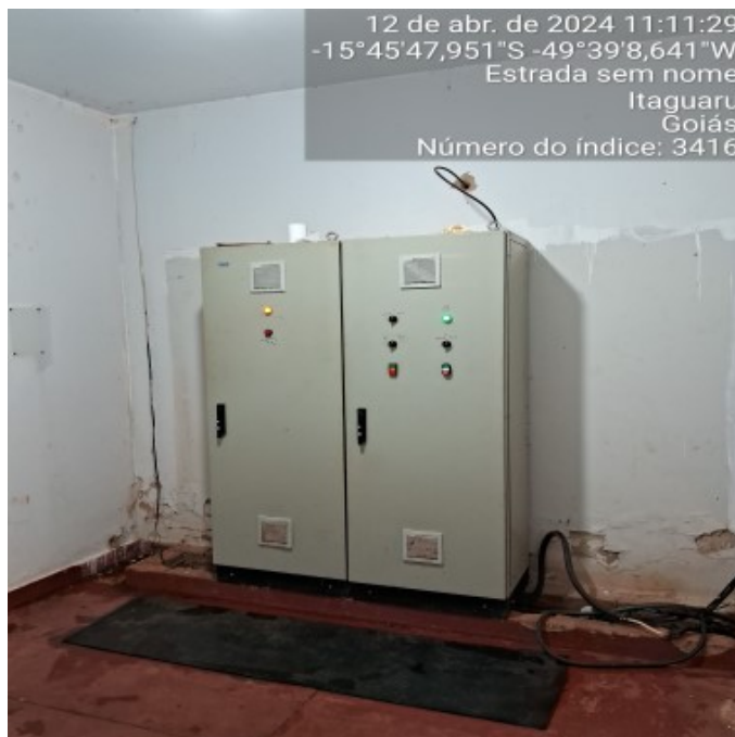
Foto 2 - Quadro de comando com área de risco sem sinalização.
