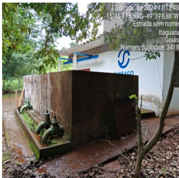
Foto 5 - Tanque de sucção/Captação com pintura desgastada.
