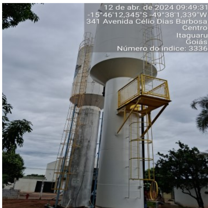
Foto 6 - REL/ETA com pintura desgastada.
