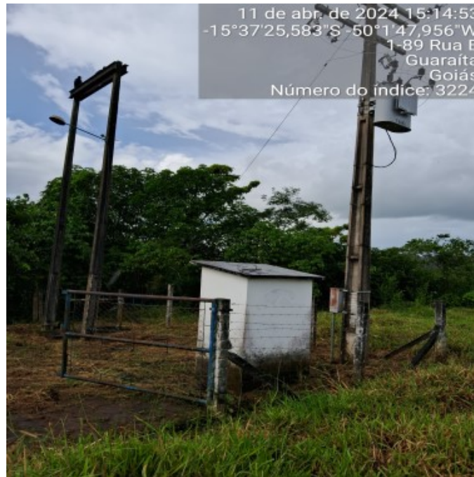
Foto 5 - Abrigo do quadro de comando com pintura desgastada.
