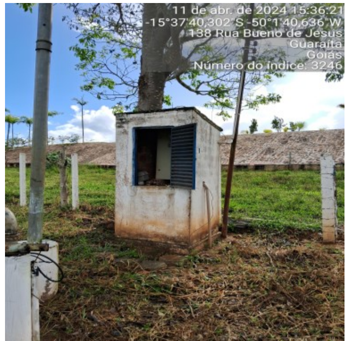
Foto 2 - Poço P10/quadro de comando sem aviso de advertência.
