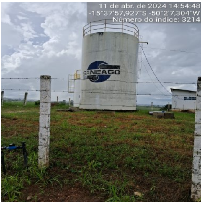
Foto 3 - RAP/C.R. 70 m³ com pintura desgastada.
