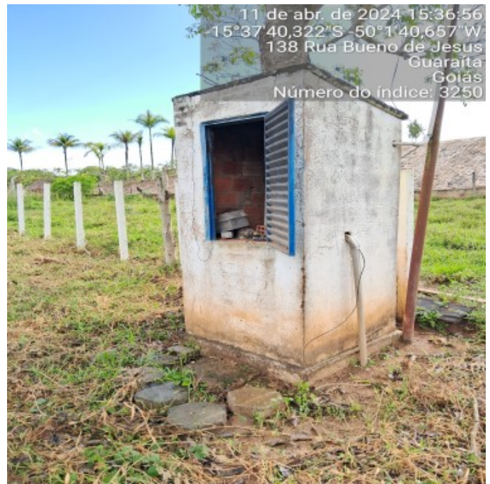
Foto 4 - Abrigo do quadro de comando com pintura desgastada.
