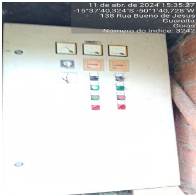
Foto 1 - Poço P08/quadro de comando sem aviso de advertência.
