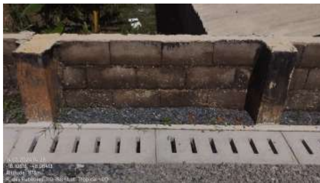
Foto 6 - Detalhes construtivos do muro de arrimo, pilares e calha de concreto e filtro de areia grossa.
