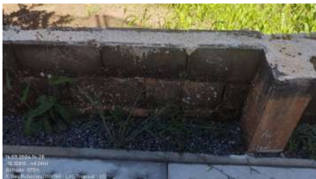
Foto 7 - Detalhes construtivos do Muro de arrimo, pilares e calha de concreto e filtro de areia grossa.
