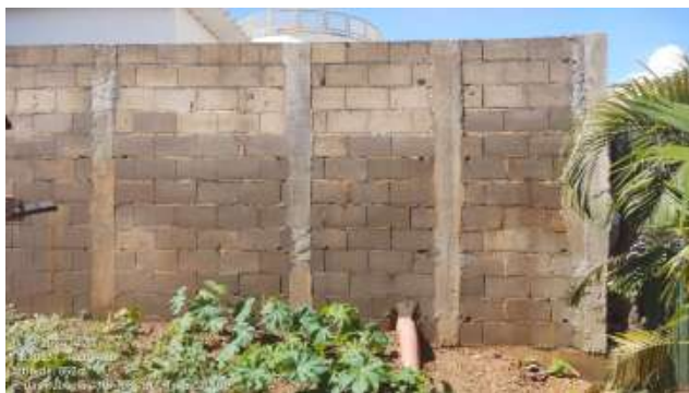
Foto 11 - Saídas da canalização da drenagem do filtro de areia (à direita).
