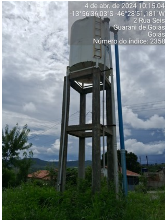
Foto 3 - Ausência de guarda corpos na escada do REL de 10 m 3 do CR da Cidade.
