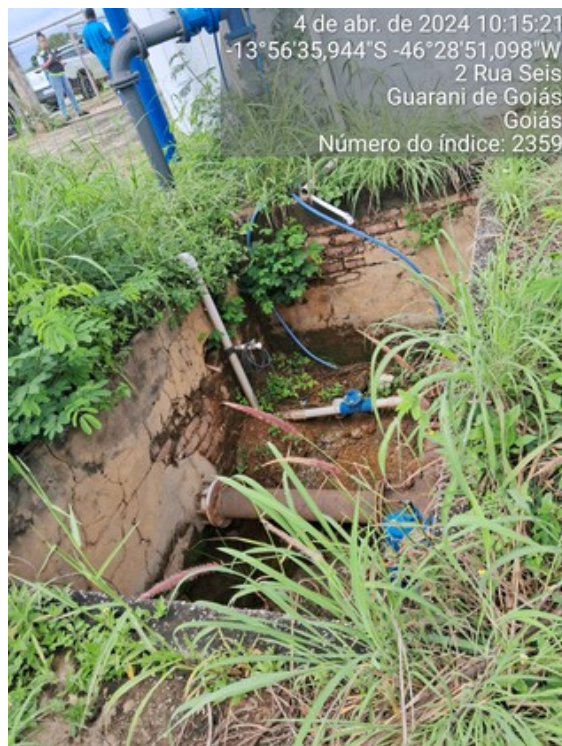
Foto 2 - Caixa de passagem sem tampa ou grade de proteção adequada no CR da Cidade.
