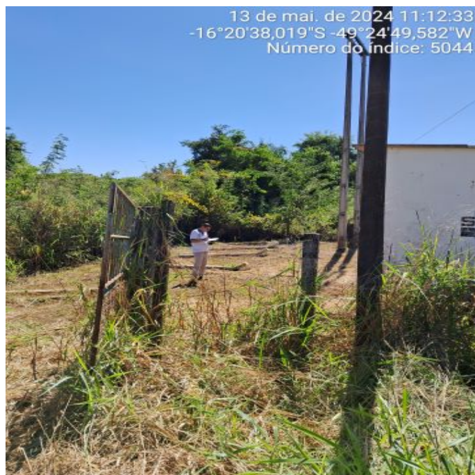
Foto 5 - Portão da área urbanizada do P2 danificado.
