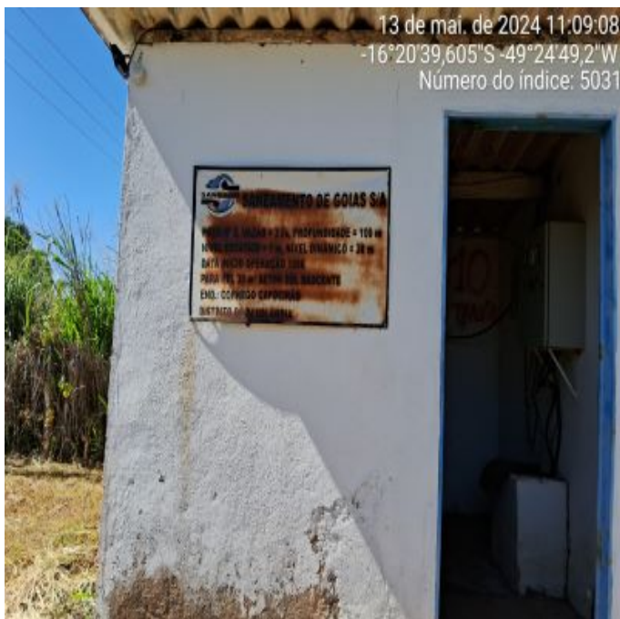
Foto 1 - Placa de identificação do P2 deteriorada (corroída).
