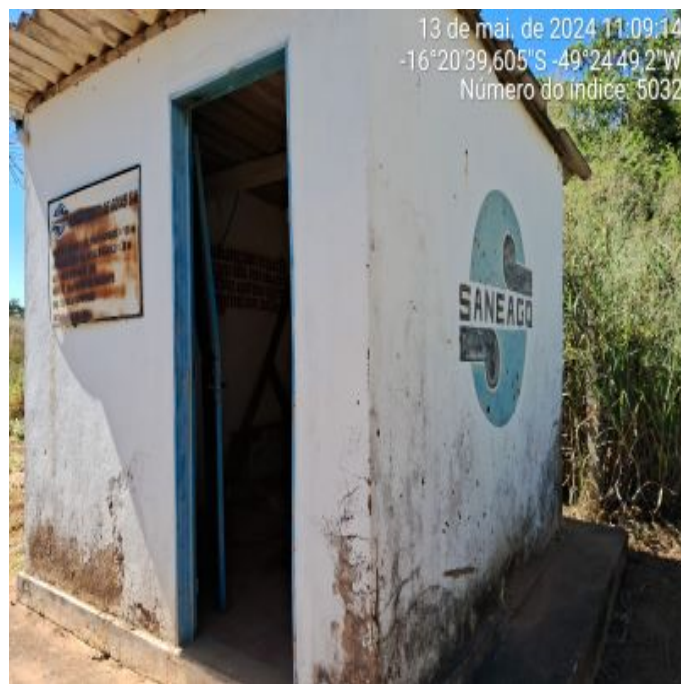
Foto 6 - Porta do abrigo do quadro de comando do P2 danificada. Pintura desgastada.
