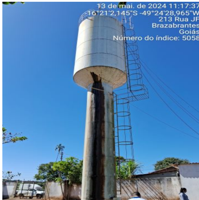
Foto 7 - REL com presença de corrosão, vazamento e pintura desgastada.
