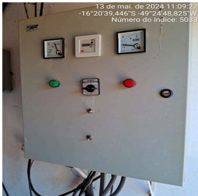
Foto 3 - Abrigo do Quadro de Comando do P2 sem aviso de advertência.
