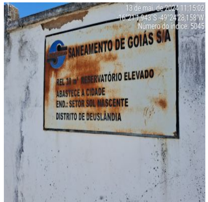
Foto 2 - Placa de identificação do REL deteriorada (corroída).
