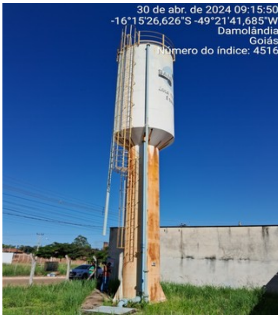
Foto 6 - Pintura desgastada do REL Jardim Esperança II.
