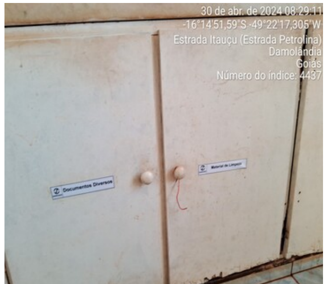
Foto 2 - Armários laboratório ETA deteriorados.
