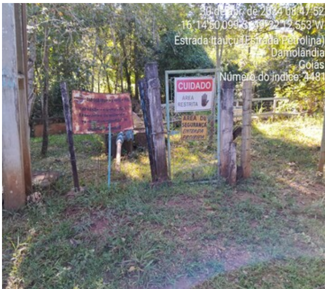
Foto 1 - Cerca de proteção da área da captação danificada.
