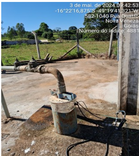
Foto 1 - Poço 12 com fiação exposta.
