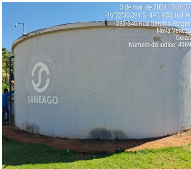
Foto 5 - RAP Exedito Stival com presença de eflorescências, perda de revestimento e pintura desgastada.
