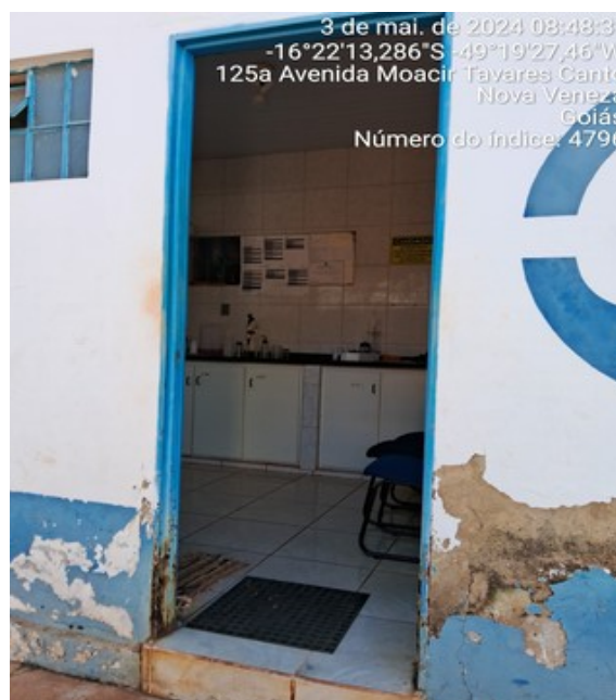
Foto 8 - Laboratório ETA com porta danificada.
