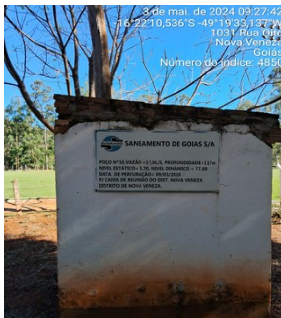
Foto 6 - Perda de revestimento no abrigo do quadro de comando do Poço 10.
