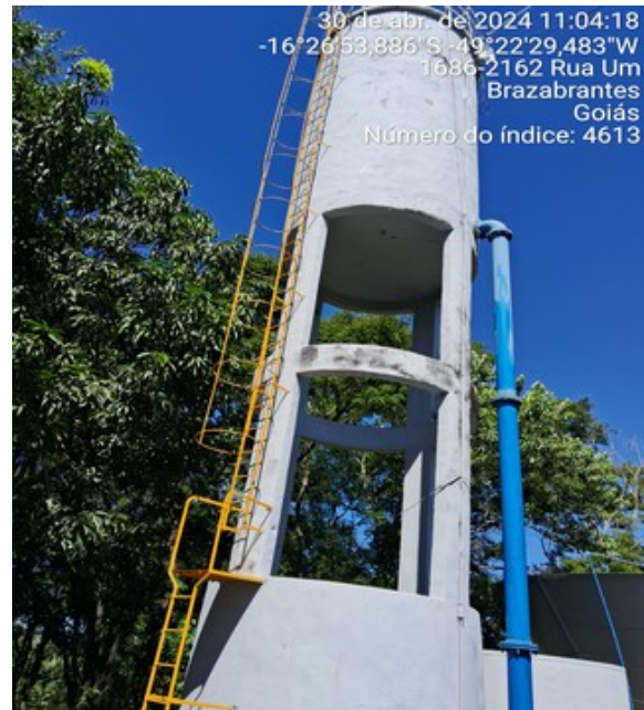
Foto 4 - REL Lavagem de filtros ETA, com pintura desgastada.
