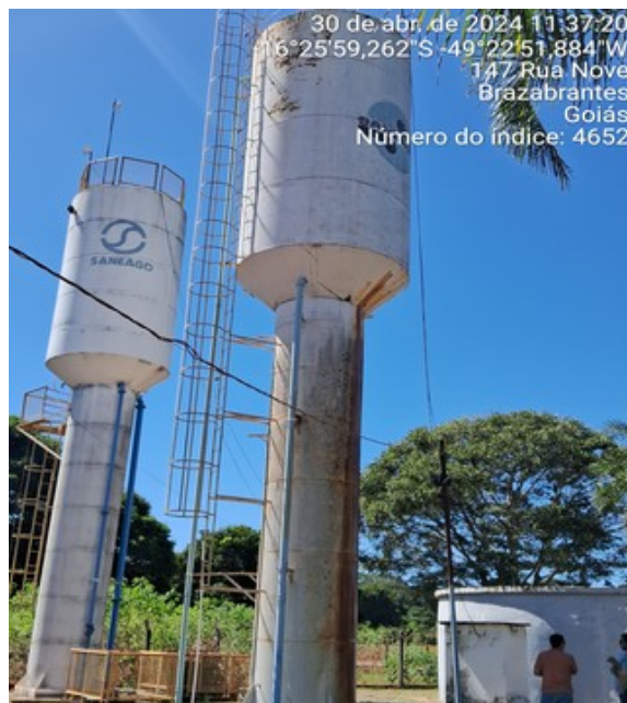
Foto 6 - REL 1 e REL 2 do CR Esplanada, com pintura desgastada.
