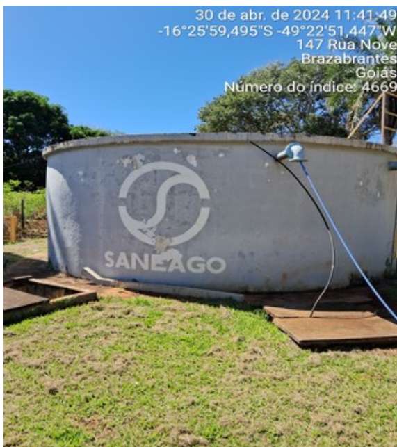
Foto 5 - RAP CR Esplanada, com pintura desgastada.
