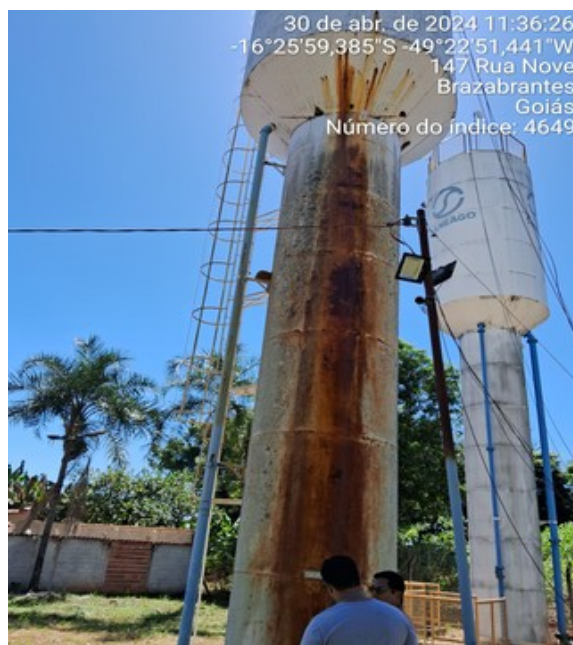
Foto 8 - REL 1 CR Esplanada, com corrosão na base.
