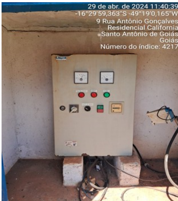
Foto 1 - Área de risco sem aviso de advertência - Quadro de Comando do Poço 05.
