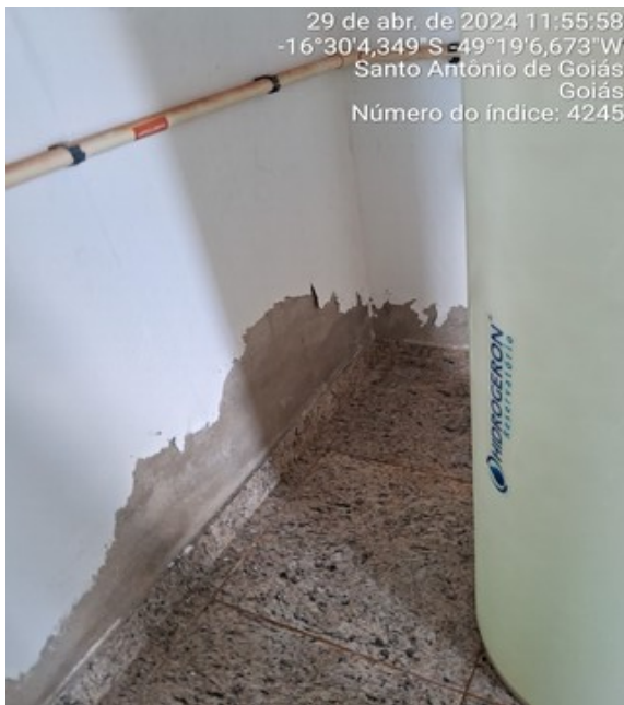
Foto 11 - Perda de revestimento interno da Casa de Cloração do CR Ipanema.
