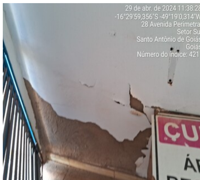
Foto 10 - Perda de revestimento interna da Casa de Cloração do CR Setor Sul - R3.
