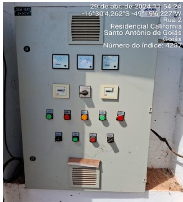
Foto 2 - Área de risco sem aviso de advertência - Quadro de Comando da EEAT - CR Ipanema.
