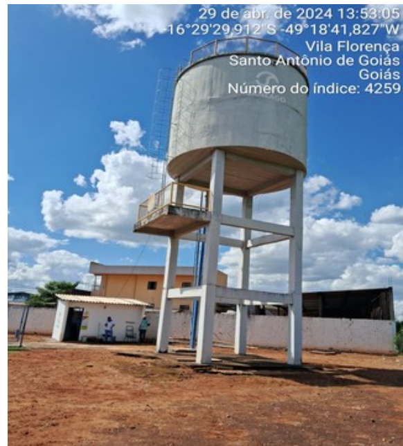
Foto 12 - REL Nilson Barnabé com pintura desgastada.
