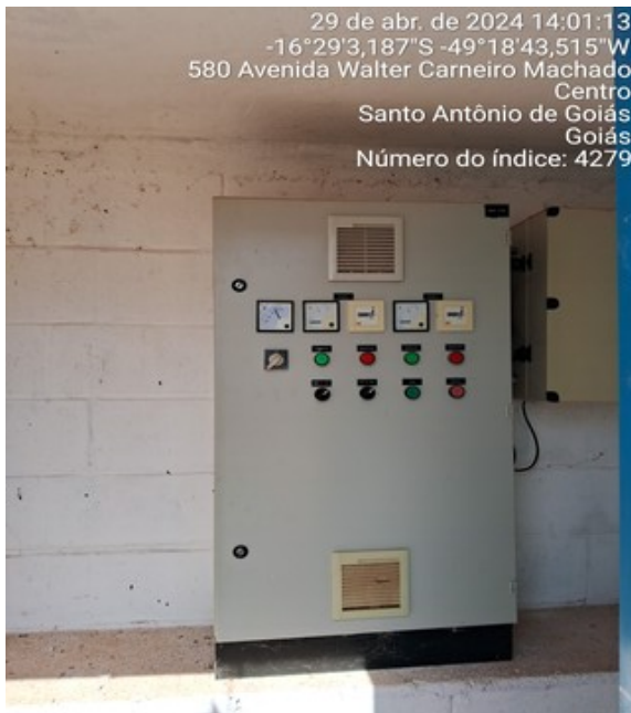
Foto 3 - Área de risco sem aviso de advertência - Quadro de Comando da EEAT - Oswaldo Alvenganga
