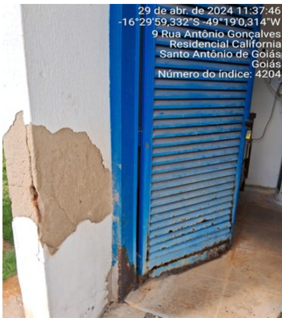
Foto 9 - Porta da Casa de Cloração danificada e perda de revestimento interno e externo - CR Setor Sul - R3.
