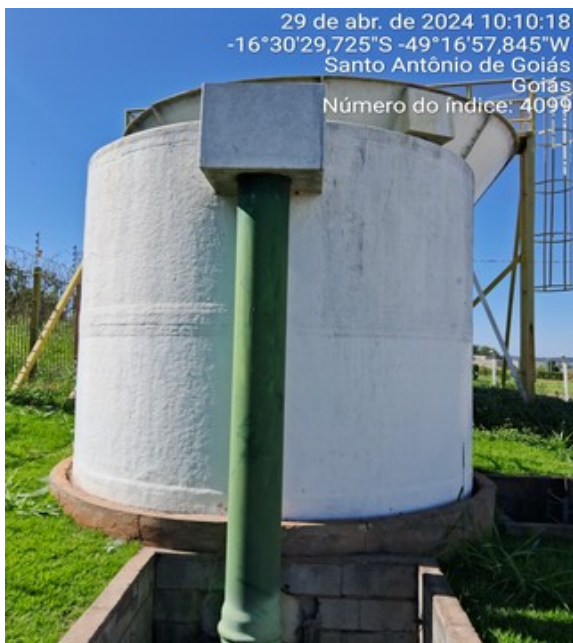
Foto 7 - Área do CR Estância do Bosque Caixa de passagem sem tampa ou grade de proteção adequada.
