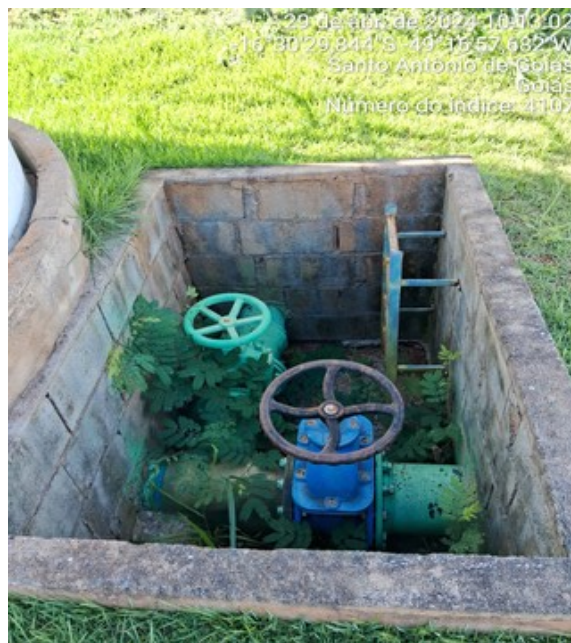
Foto 8 - Área do CR Estância do Bosque Caixa de passagem sem tampa ou grade de proteção adequada.
