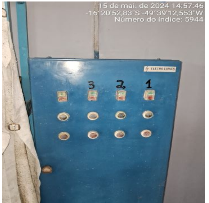
Foto 4 - Quadro de Comando dos misturadores sem aviso de advertência.
