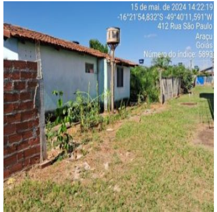
Foto 2 - Muro quebrado/danificado na área do CR e EEAT/GO 222.
