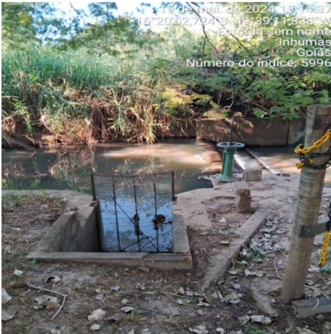
Foto 1 - Ausência de grade de proteção superior do canal que leva a água do córrego ao poço de sucção.
