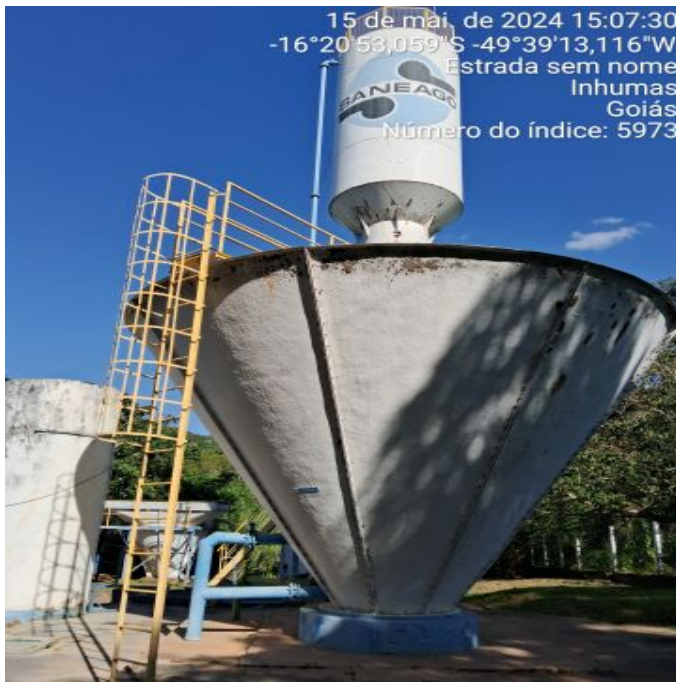
Foto 5 - Floco decantador com pintura desgastada.
