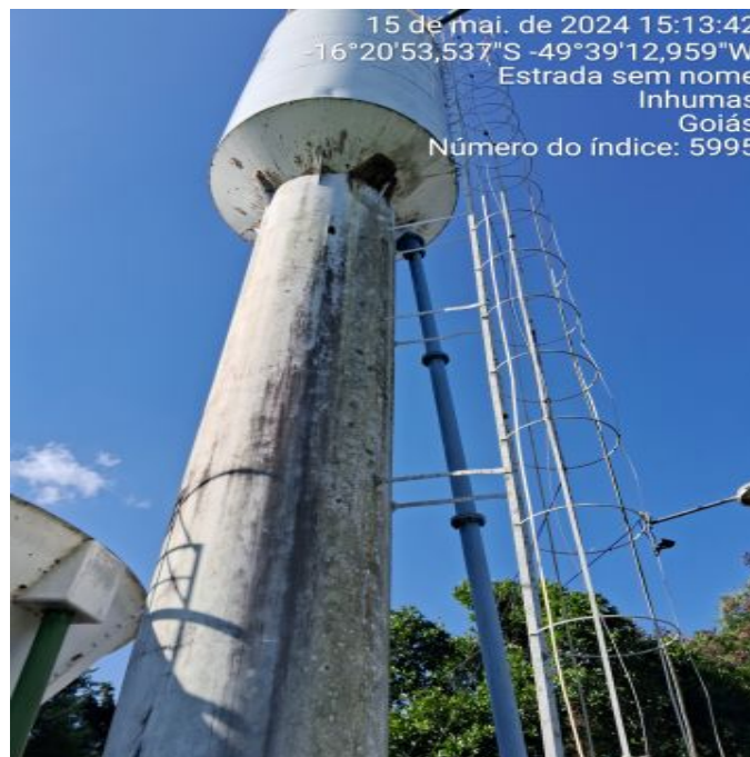
Foto 7 - REL Lavagem de filtro ETA com pintura desgastada.
