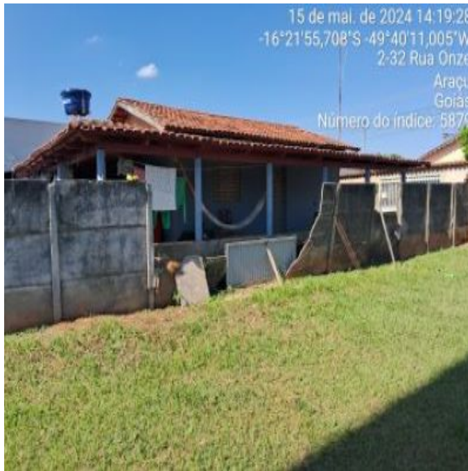
Foto 3 - Muro quebrado/danificado na área do CR e EEAT GO 222.
