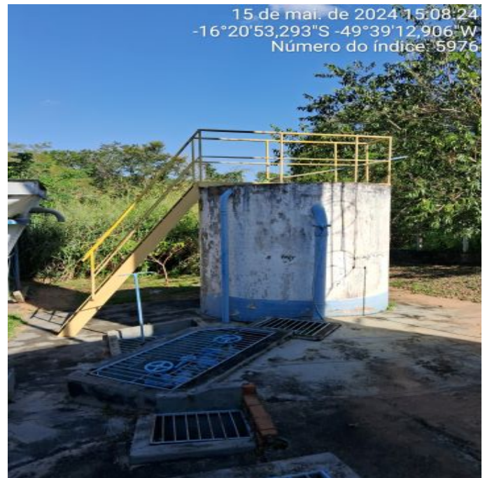
Foto 6 - Filtro Russo com pintura desgastada.
