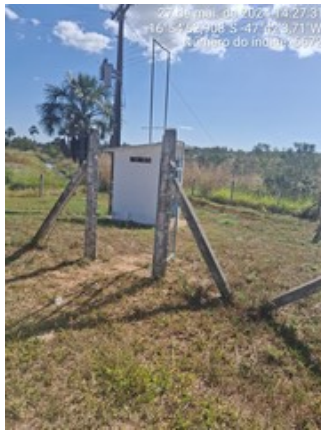
Foto 4 - Cerca danificada - Poço P1
