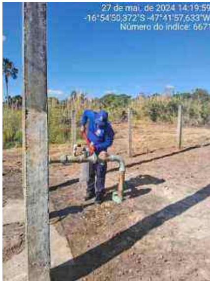
Foto 2 - Vazamento no poço P 2.
