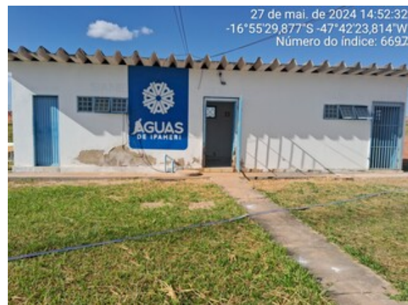
Foto 5 - Perda de revestimento - EEAT/CR.
