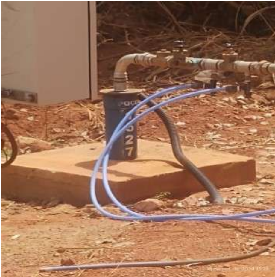
Foto 1 - Poço 1527 perfurado e interligado ao sistema.
