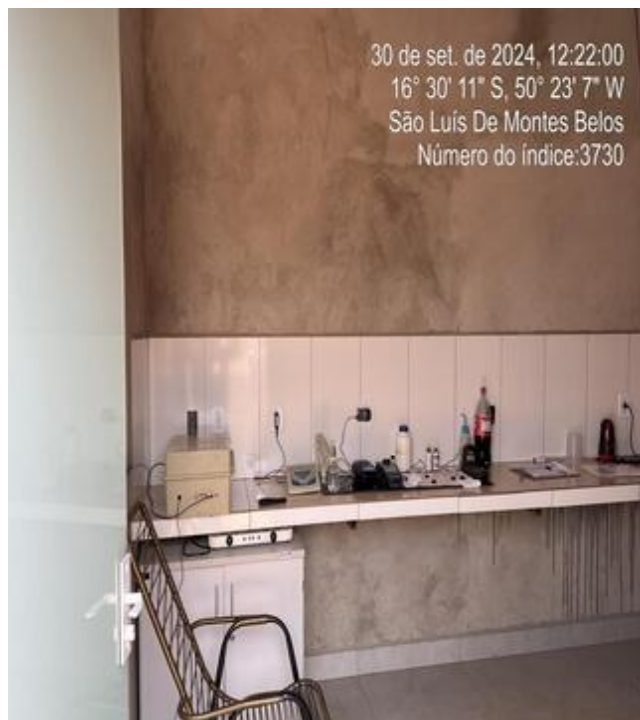
Foto 7 - ETA/Laboratório sistema Santa Rosa, Vila Aeroporto.
