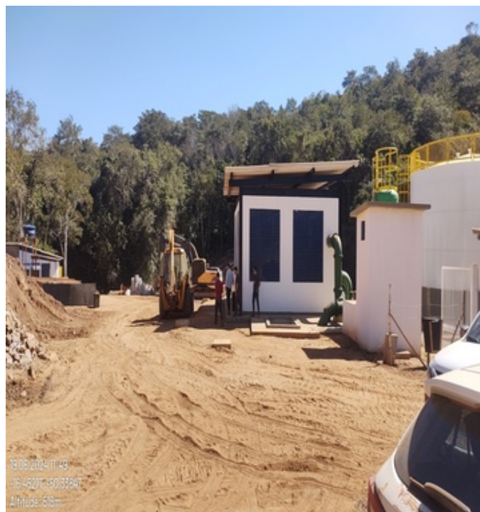
Foto 8 - Captação/EEAB Ribeirão Santa Rosa à montante da captação sistema Santa Rosa, em fase de conclusão.
