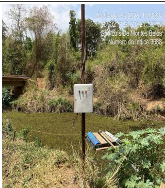
Foto 2 - Captação provisória a jusante da captação a montante no Ribeirão Santana.
